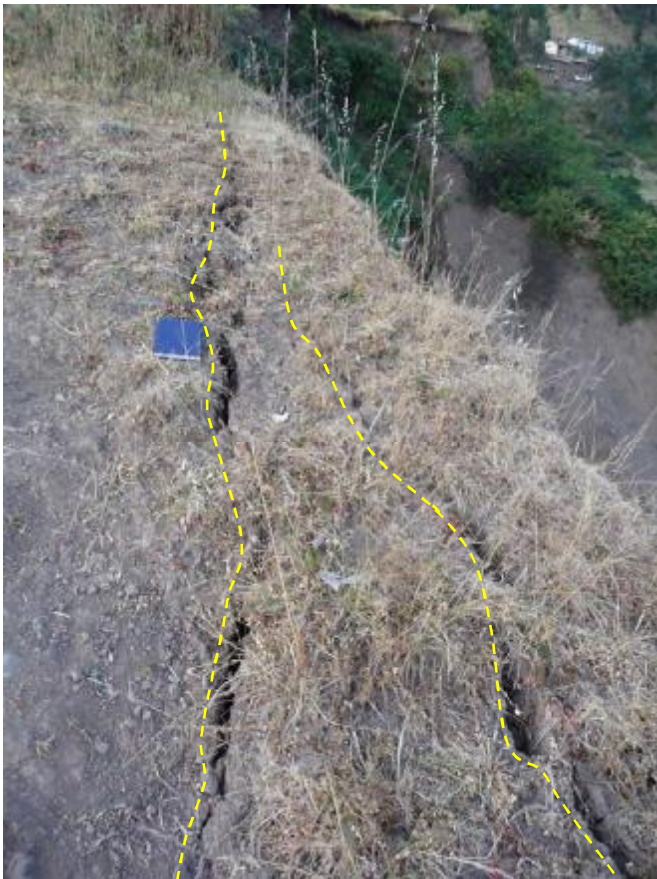
Foto. N° 15 Presencia de agrietamiento sector Manzanapata, al borde del derrumbe
