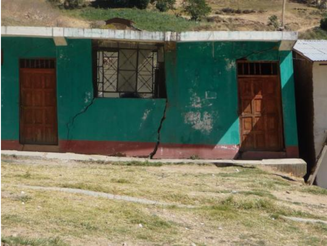
Foto N° 8 se muestra la Infraestructura de la Institución Educativa fisurada
