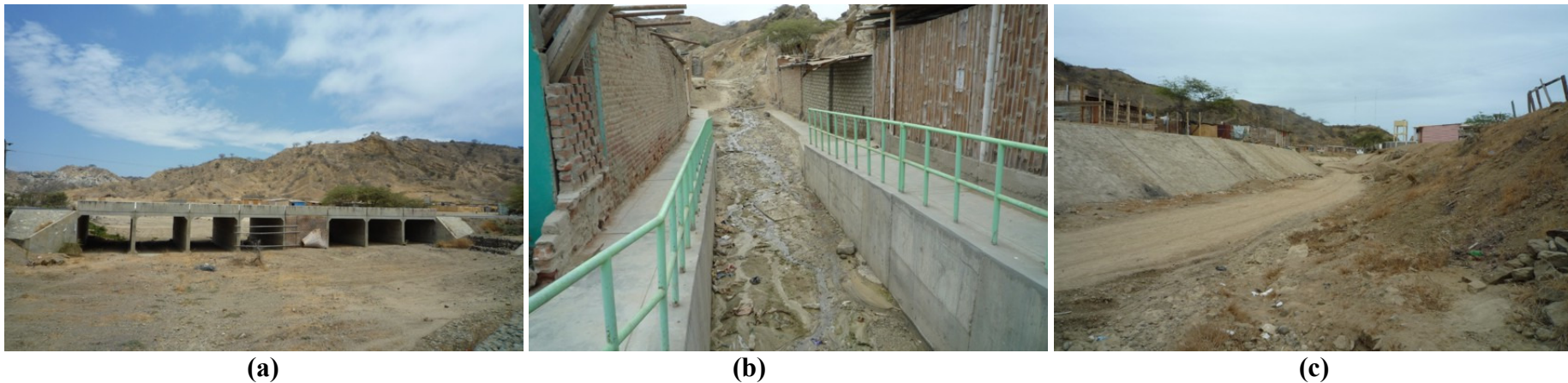
Panamericana Norte entre quebrada Plateritos, Cancas, desvío Punta Sal. (a).- Quebrada que cruza la Panamericana Norte a un costado del desvío ha Punta Sal, se puede observar la utilización del puente como vivienda, por esta torrencera discurren flujos excepcionalmente. (b).- Poblado de Cancas, torrenceras secas, por donde discurren flujos de lodo y cruzan la Panamericana Norte a la altura del km 174+397. (c).- Quebrada por donde excepcionalmente discurren flujos de lodo y detritos, se observa los muros de encauzamiento a la margen izquierda, sector Señor de los Milagros.
