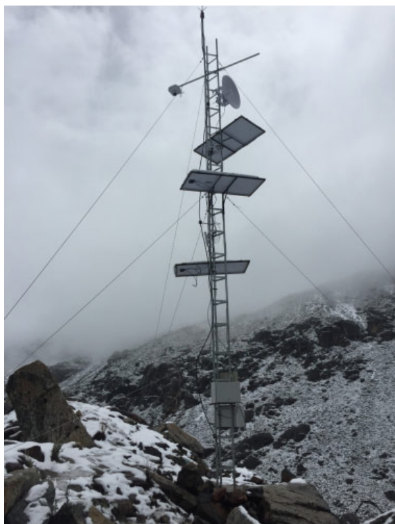
Fotografía 17. Torre de transmisión instalada en la morrena lateral izquierda de la laguna Palcacocha.
