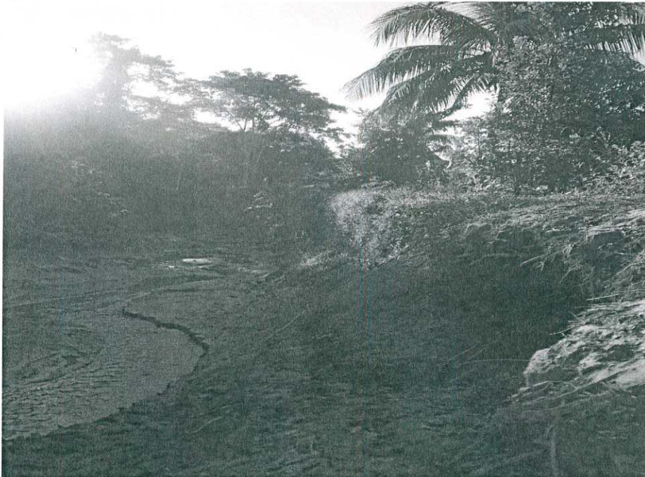
Erosión de la Qda. Gervacio ubicado en la desembocadura al río Huayabamba.
