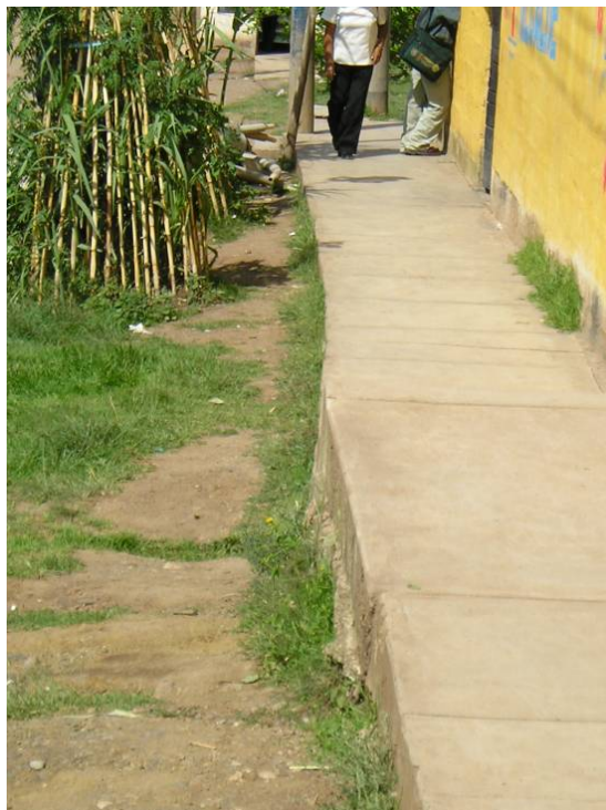
Foto – 45: Gran desplazamiento en aceras que fueron construidas en línea recta.
