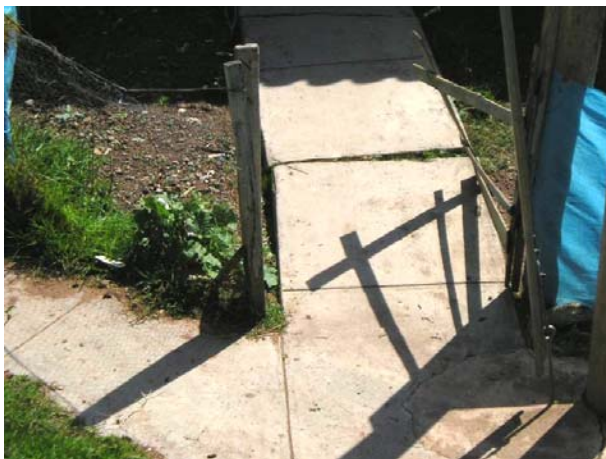
Foto – 43: Aceras con giro horizontal, podrían ser en parte movimientos recientes.
