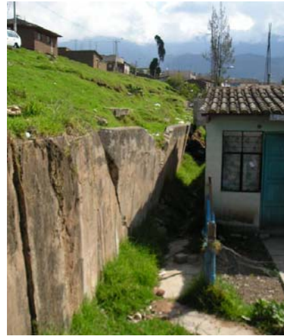
Foto – 40: La fotografía es idéntica a otras tomadas en 1997, la falla de los muros no progresa en los últimos años.
