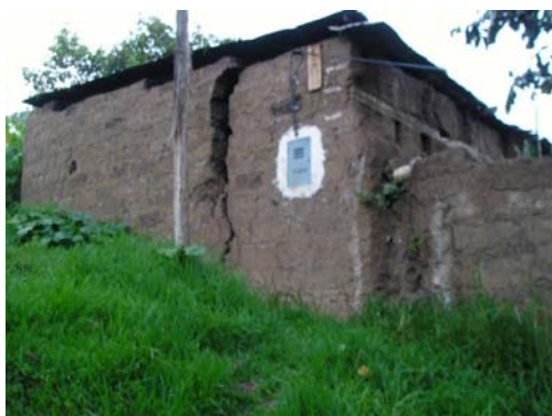
Foto – 37: Vivienda rajada por asentamientos del suelo en el sector de Limapata
