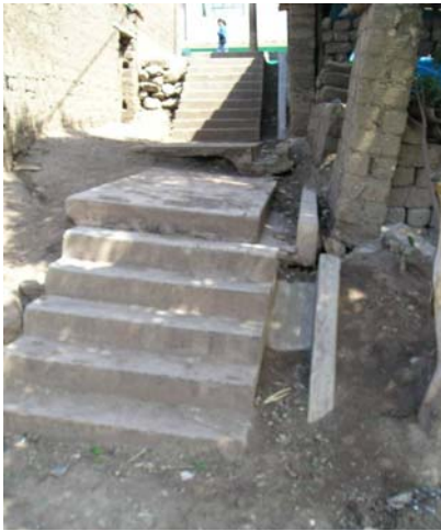
Foto – 39: Las escaleras que se muestran fueron construidas recientemente sobre material de relleno, los daños no son atribuibles al fenómeno de reptación estudiado.
