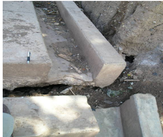
Foto – 44: Grietas de construcciones recientes hechas sobre relleno, no atribuibles al proceso de reptación FONAVI
