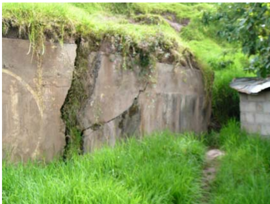
Foto – 41: Los daños observados son iguales a los observados en informes antiguos.
