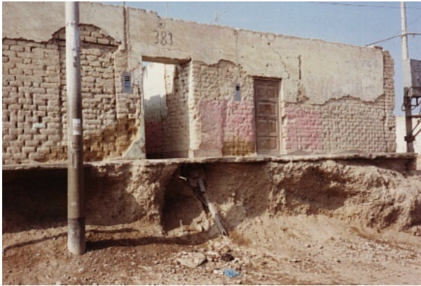
VULNERABILIDAD EN EDIFICACIONES: SOCAVACION DEL SUELO DE CIMENTACION
