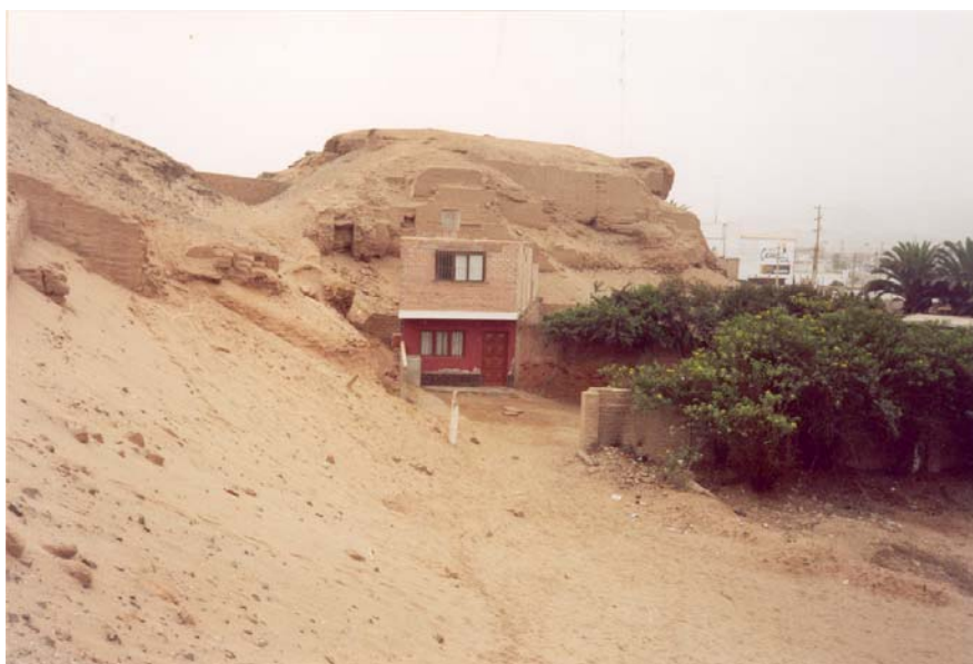
FOTO: 7 Muestra de una vivienda expuesta a mayor riesgo por derrumbe del material de arena y arcilla que se encuentra a su alrededor.
