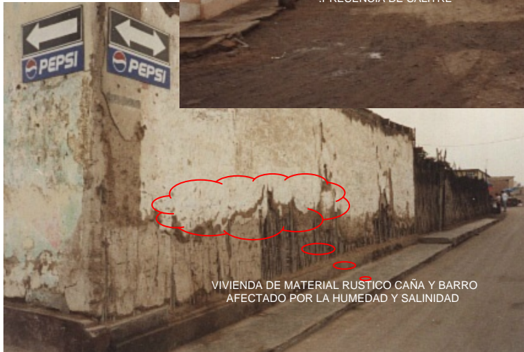
CALLE ESTRECHA SIN ASFALTAR - VIVIENDAS DE MATERIAL RUSTICO Y MATERIAL NOBLE .PRESENCIA DE SALITRE
