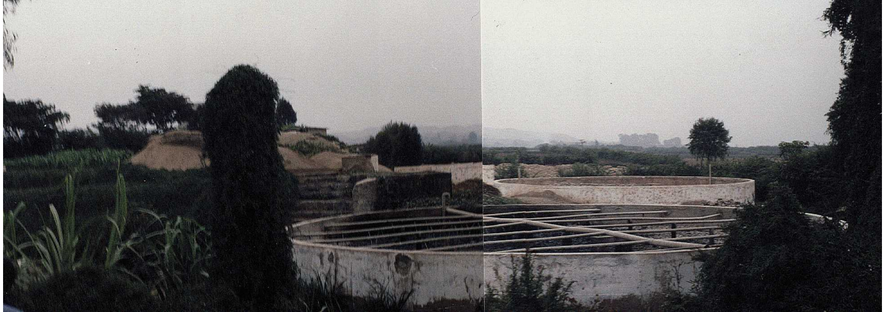
PLANTA DE TRATAMIENTO DE AGUAS SERVIDAS DEL DISTRITO DE NUEVO IMPERIAL
