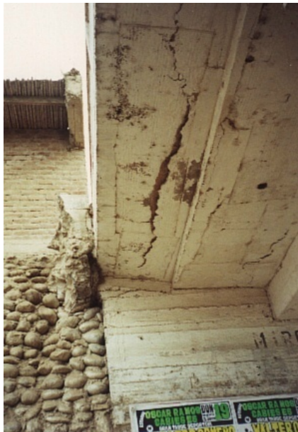
PUENTE 15 DE NOVIEMBRE RIESGO DE COLAPSO POR ANTIGÜEDAD Y MAL USO, PRESENTA AGRIETAMIENTO DE LA LOSA
