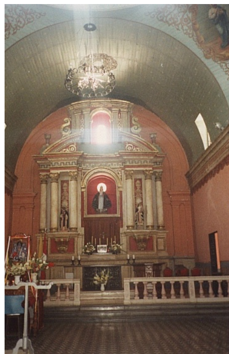
ALTAR MAYOR DE LA IGLESIA PRESTA DETERIORO EN LA PARTE DE LA CUPULA
