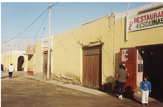
EDIFICACIONES CON PROBLEMAS DE HUMEDAD Y SALITRE
