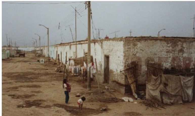
VIVIENDA DETERIORADA POR EL INTEMPERISMO
