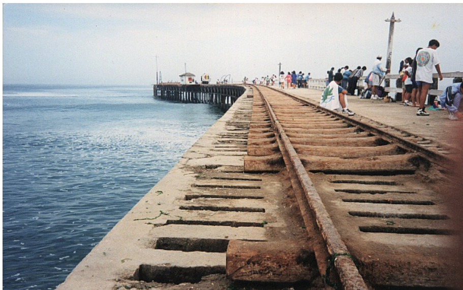
FOTO.1. Condiciones del Muelle. Note la agresividad de la erosión marina sobre su estructura.
