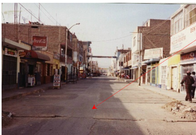
VIA EN EL AREA URBANA CON LA CARPETA ASFALTICA EN MAL ESTADO : DISTRITO DE IMPERIAL
