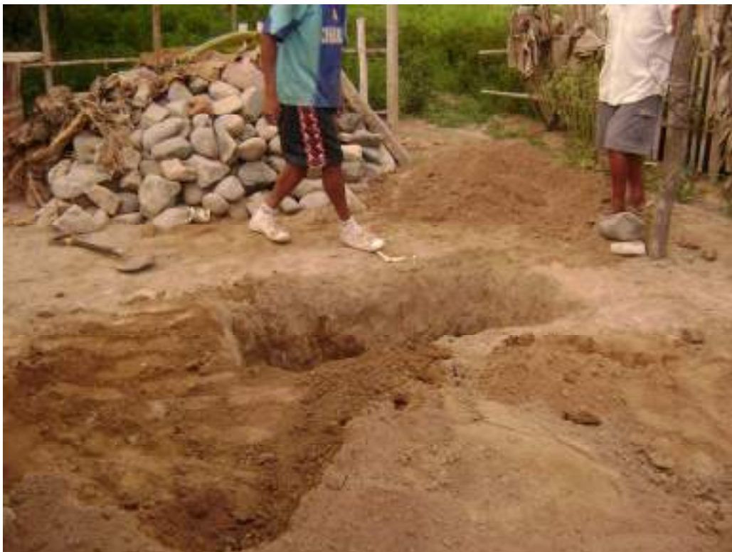
FOTO N° 07: Calicata N°16, ubicado en el Bosque de Sunampe, el suelo corresponde a un material areno limoso, sin piedras.
