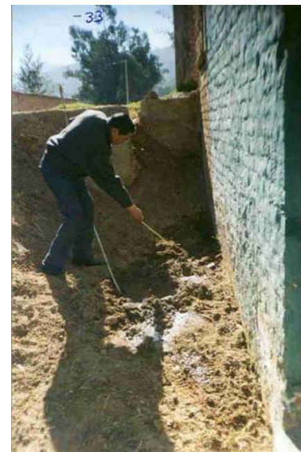
FILTRACIONES DEL CANAL REMONTA I DENTRO DE LA ZONA URBANA
