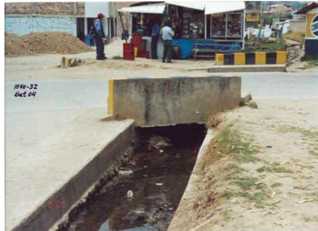
CANAL REMONTA I O CANAL INIA, CRUZANDO BAÑOS CERCADO, MOSTRANDO EN TODA SU MAGNITUD LA CONTAMINACIÓN CON AGUAS NEGRAS Y RESIDUOS SÓLIDOS. ESTE PUNTO CORRESPONDE A LA INTERSECCIÓN DE ESTE CANAL CON LA AV. MANCO CAPAC A 2 CUADRAS DE LA PLAZA DEL DISTRITO
