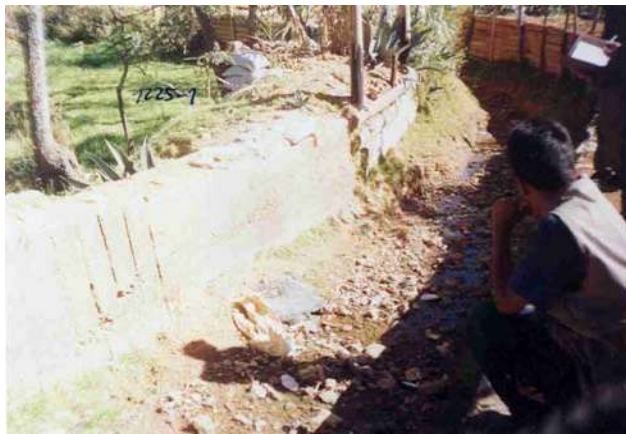
DEFENSAS RIBEREÑAS RUSTICAS CONSTRUIDAS POR LOS MORADORES PARA EVITAR INUNDACIONES PROVOCADAS POR LAS AVENIDAS EN LA QUEBRADA SECA TINGO MAYO, ALREDEDORES DE LA ZONA DE LAGUNA SECA.
