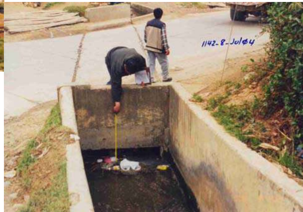
LADO IZQUIERDO DEL CANAL REMONTA 2, LUGAR DONDE LAVAN VEHÍCULOS Y SE VIERTEN BASURA, ACEITES, PAPELES, PLASTICOS
