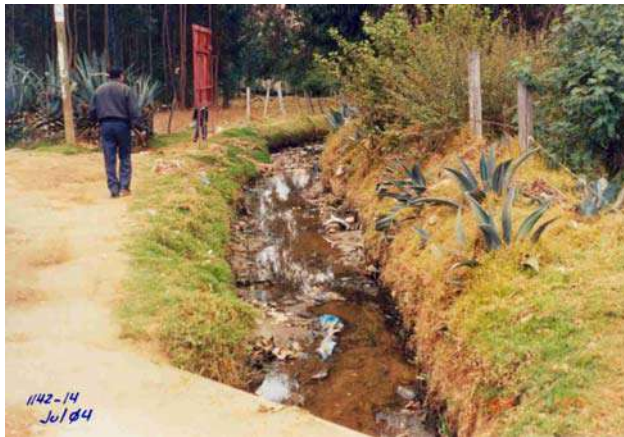
CANAL REMONTA SIN OBRAS DE ARTE, COMPLETAMENTE DESCUIDADO Y ES USADO COMO BOTADERO DE RESIDUOS
