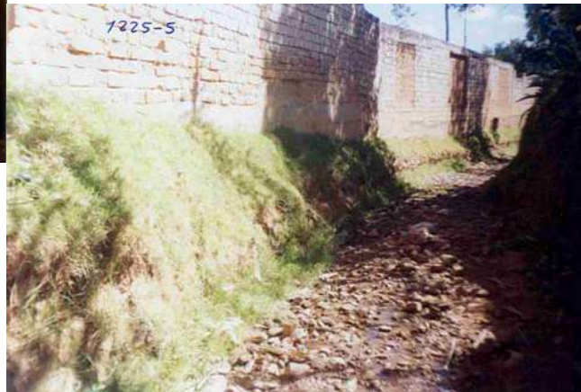
CONSTRUCCIONES QUE COLINDAN CON LA QUEBRADA SECA TINGO MAYO, MUESTRAN RASGOS DE EROSION LATERAL, QUE EN CASO DE CONTINUAR PODRIAN PRODUCIR COLAPSO DE LAS ESTRUCTURAS Y UNA FUERTE INUNDACION
