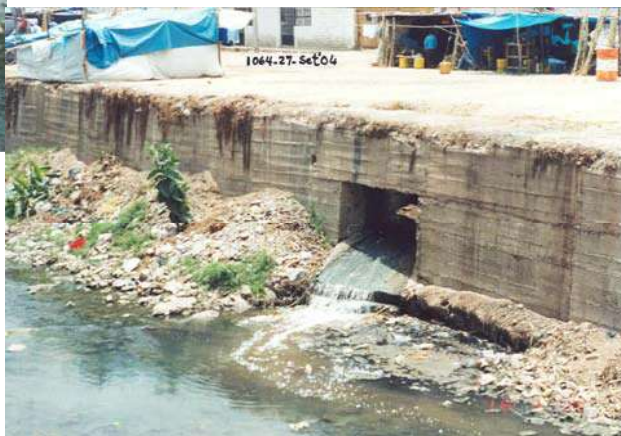
VERTIDO DE AGUAS NEGRAS A 100 DE LA CARRETERA DE INGRESO A LOS BAÑOS DEL INCA
