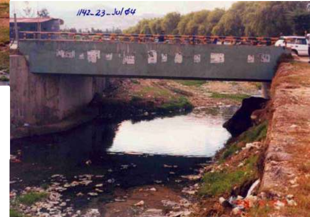
ACUMULACIONES DE AGUAS NEGRAS Y BASURA DEBAJO DEL PUENTE PRINCIPAL DE INGRESO AL BALNEARIO BAÑOS DEL INCA.
