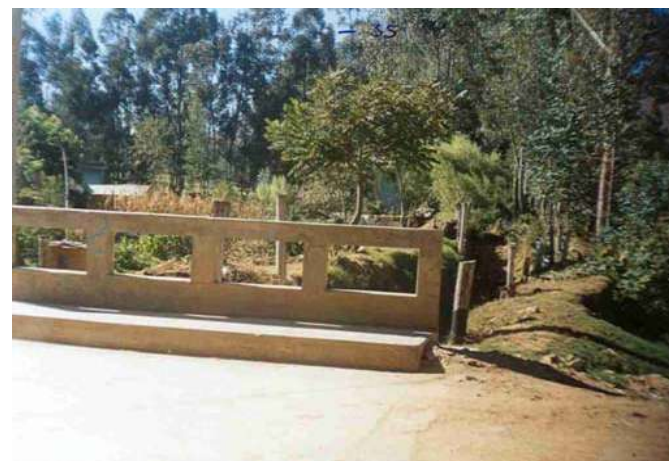
PUNTO DE DESBORDES UBICADO EN LA INTERSECCIÓN DE LA QUEBRADA TINGO MAYO CON LA AV. LOS EUCALIPTOS
