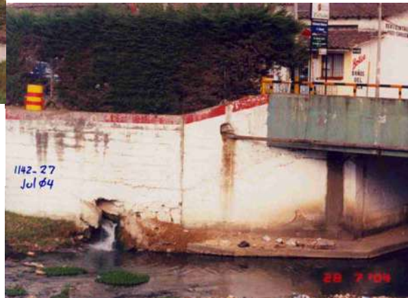
PUNTOS DE DESCARGAS DE AGUAS SERVIDAS Y AGUAS DE LAS PISCINAS TEMPERADAS CERCANAS AL PUENTE PRINCIPAL
