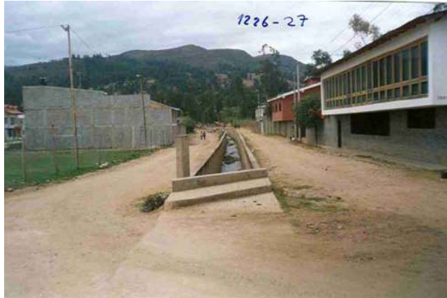
TRAMO DE DESBORDES DE LA QUEBRADA SECA TINGO MAYO HACIA LA URBANIZACIÓN LAGUNA SECA. EL AGUA EN AVENIDAS PROVIENE DE LA QUEBRADA Y DEL TRAGADERO
