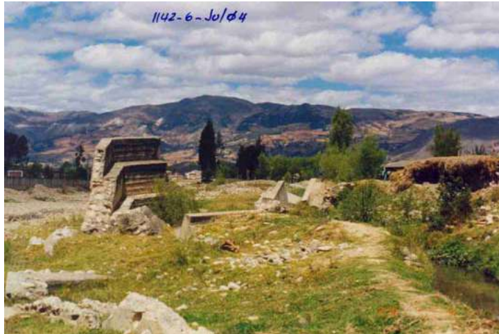
MARGEN DERECHA DEL RIO CHONTA, MOSTRANDO ACUMULACIONES DE MATERIALES ALUVIO-FLUVIALES. SE ENCUENTRAN RESTOS DE UNA ESTRUCTURA DE DISTRIBUCIÓN QUE HA SIDO DESTRUIDA POR LA ENERGÍA CINÉTICA DEL RÍO
