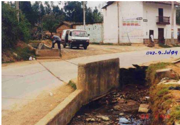
INTERSECCION REMONTA 2 CON AV. MANCO CAPAC. ACUMULACIÓN DE RESIDUOS SOLIDOS Y AGUAS CONTAMINADAS
