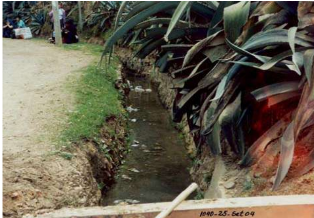
SECTOR DEL CANAL CON AGUAS CONTAMIANADAS Y ESTANCADAS AUN SIN PROCESO DE LIMPIEZA
