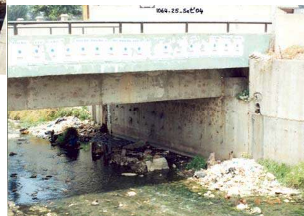
RESIDUOS SOLIDOS DENTRO DEL RIO
