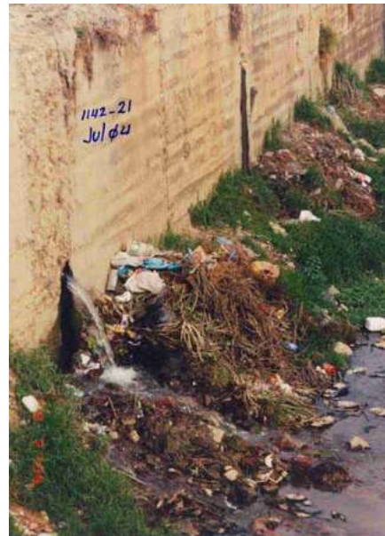
PUNTO DE DESCARGA DE LAS TUBERÍAS DE DESAGUE, ASI COMO BOTADERO DE BASURA
