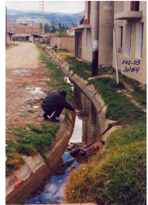
CANAL REVESTIDO AL COSTADO DE LA URB. HURTADO MILLER A LA ENTRADA DE BAÑOS DEL INCA. SE ENCUENTRA FUERTEMENTE CONTAMINADA POR LA PRESENCIA DE RESIDUOS CONTAMINANTES SOLIDOS Y LIQUIDOS VISTA DEL SECTOR NORTE
