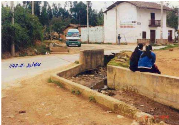
PARTE DEL CANAL CON FUERTE SEDIMENTACIÓN Y MUCHA BASURA
