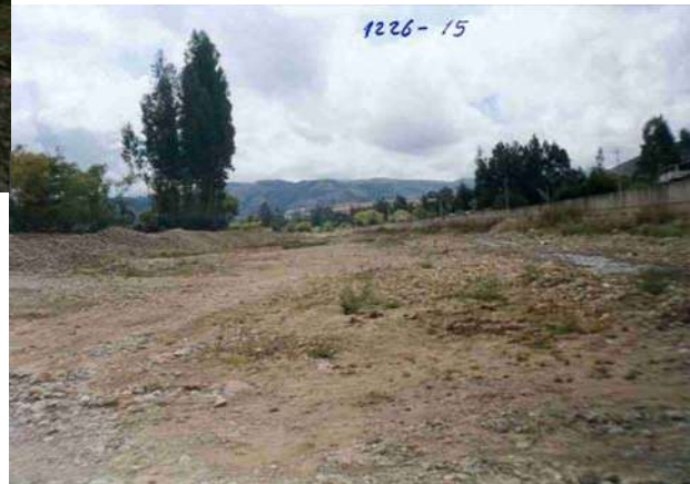
DEFENSAS RIBEREÑAS DE ENROCADO EN LA MARGEN DERECHA DEL RIO CHONTA. ES UNA ESTRUCTURA MUY DEBIL Y GENERALMENTE ES ARRASADO EN LAS MAXIMAS AVENIDAS DEL RIO
