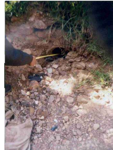
ORIFICIO CONSTRUIDO EN LA MARGEN DERECHA DE LA QUEBRADA TINGO MAYO PARA DERIVAR AGUA HACIA LOS TERRENOS DE CULTIVOS
