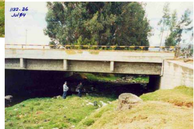
CONCENTRACIÓN DE MATERIALES GRUESOS HASTA FINOS PRODUCTO DE LAS AVENIDAS EN EL RIO MASHCON. ES UNA ZONA DE DESBORDE E INUNDACIONES
