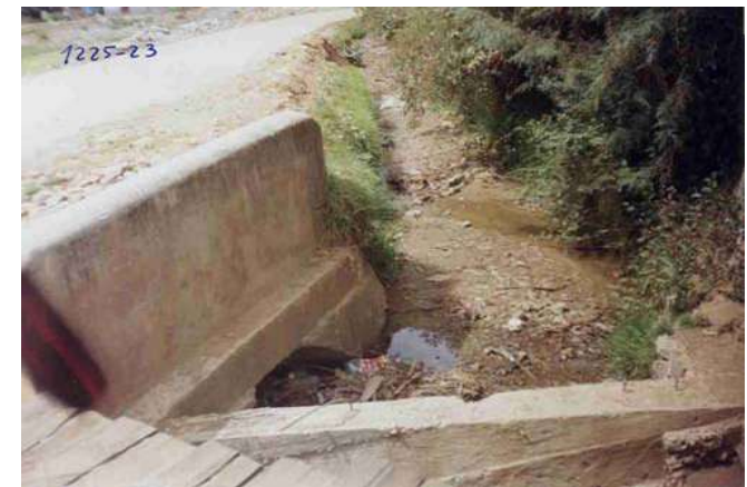
ESTADO DE LA DESEMBOCADURA DE LA QUEBRADA Mayopata HACIA EL CANAL REMONTA 2. LOS SEDIMENTOS PROVIENEN DE LA QUEBRADA
