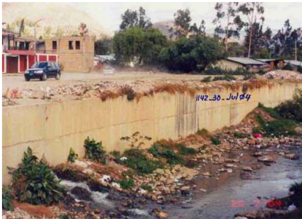
OTRO PUNTO DE DESCARGA DE LAS AGUAS SERVIDAS AL RIO CHONTA. TODA LA MARGEN IZQUIERDA SE HA CONVERTIDO EN BOTADERO DE BASURA
