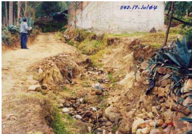
TRIBUTARIO AL CANAL REMONTA 2, DE FUERTES AVENIDAS EN TIEMPO DE LLUVIAS
