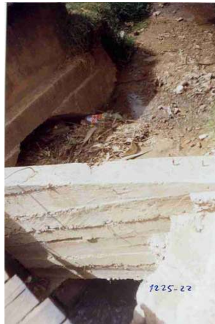
EL CANAL REMONTA 2 PASA POR DEBAJO DE LA DESEMBOCADURA TAPANDO EL CANAL EN UNA LONGITUD DE 40 METROS MEDIANTE UNA LOSA DE CONCRETO, PERO LOS SEDIMENTOS Y EL AGUA DE LA QUEBRADA Mayopata SIEMPRE INGRESAN TOTALMENTE AL CANAL Y LUEGO SE DESBORDAN EN MAXIMAS AVENIDAS
