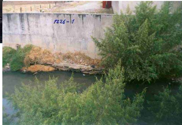
SOCAVAMIENTO DEL MURO DE ENCAUSAMIENTO DEL RIO CHONTA, FENÓMENO COMUN EN MUCHOS PUNTOS A LO LARGO DEL CAUCE
