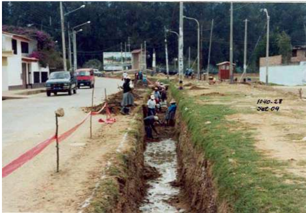
TRAZO Y ARRÉGLLO DEL CANAL LAGUNA SECA CERCANO A LA INTERSECCION CON EL CANAL REMONTA I
