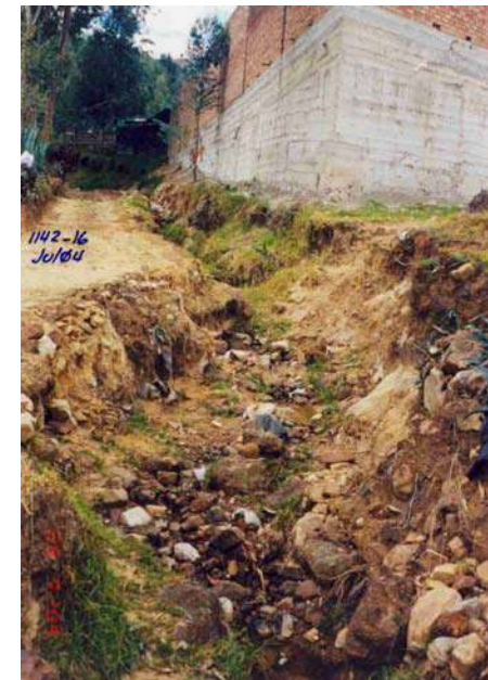
TRIBUTARIO AL CANAL REMONTA 2 QUE EN TIEMPO DE LLUVIAS VIERTE GRAN CANTIDAD DE AGUA
