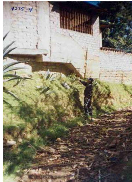
ING. HUAMAN SEÑALANDO EL NIVEL HASTA DONDE LLEGA EL TIRANTE DEL AGUA CUANDO NOS ENCONTRAMOS EN EPOCAS DE FUERTE LLUVIAS
