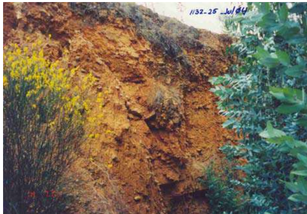
TALUDES EN LA QUEBRADA TINGO MAYO, EN LA ZONA ESTE DE SHAULLO, CON PENDIENTES CASI VERTICALES, FUERTEMENTE METEORIZADAS Y LIMONITIZADAS. SE ENCUENTRAN FUERA DEL AREA DE ESTUDIO Y PRESENTAN CONDICION SEMIESTABLE A ESTABLE
