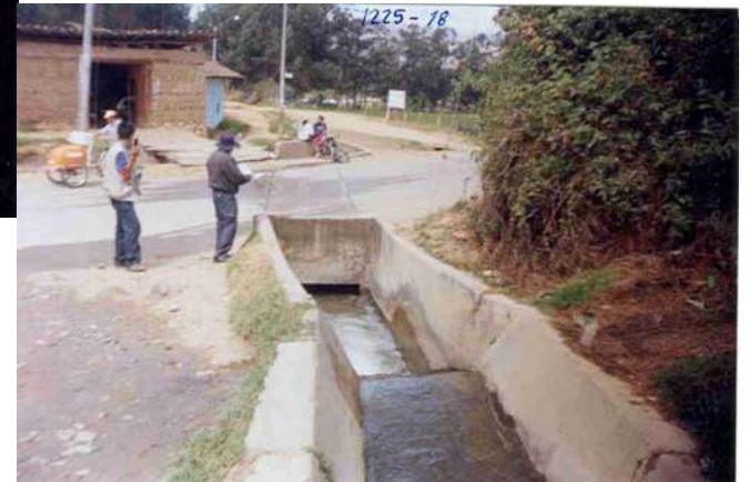
PUNTO CRITICO DE DESBORDES E INUNDACIONES UBICADO EN LA INTERSECCION DE LA AV. MANCO CAPAC, JR. LA LIBERTAD Y AV. LOS EUCALIPTOS
