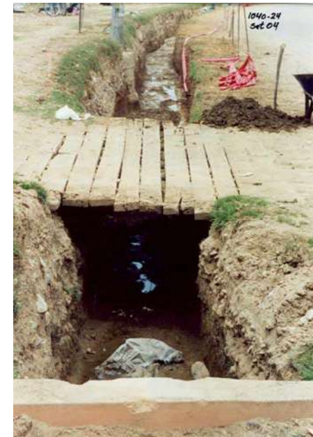
TRAMO CERCANO AL INGRESO A LA LAGUNA SECA AUN NO LIMPIADO CON PRESENCIA DE BASURA Y AGUAS NEGRAS
