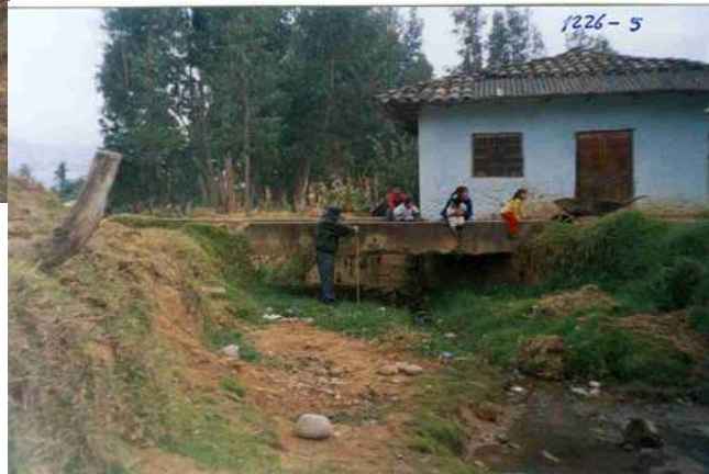
PUNTO DE DESBORDES DE LA QUEBRADA SECA TINGO MAYO. LA SECCION SE HA REDUCIDO BAJO EL PONTON DE LA CALLE LAS ARENAS
