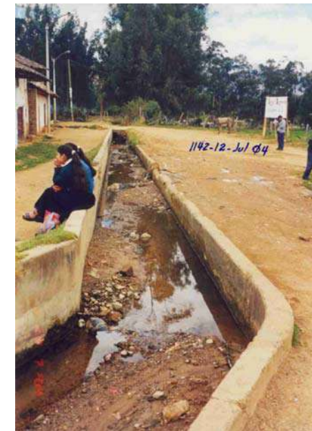
CANAL REMONTA CON MATERIALES DE SEDIMENTACIÓN Y AGUAS ESTANCADAS
