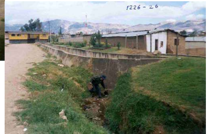
PUNTO CRITICO DONDE SE UNEN LA ACEQUIA QUE PASA POR LA AV. MANCO CAPAC Y LA QUEBRADA SECA TINGO MAYO. EL AGUA DESBORDA HACIA LA CALLE EN MAXIMAS AVENIDAS
