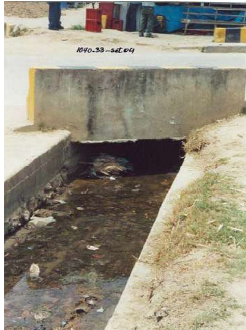
CANAL REMONTA I O CANAL INIA, CRUZANDO BAÑOS CERCADO, MOSTRANDO EN TODA SU MAGNITUD LA CONTAMINACIÓN CON AGUAS NEGRAS Y RESIDUOS SÓLIDOS.
