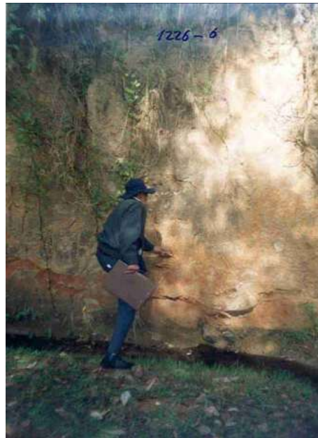
TALUDES CASI VERTICALES AFECTADOS POR PROCESOS DE SATURACIÓN Y EMPUJES LATERALES. EN EL PISO SE NOTA LA EROSIÓN DE FONDO Y LATERAL
