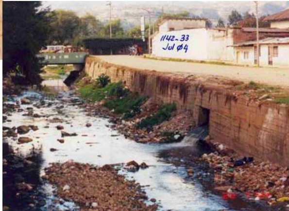
PANORAMICA SIMILAR QUE LA ANTERIOR, MOSTRANDO LOS PUNTOS DE DESCARGA DE AGUAS NEGRAS Y RESIDUOS SOLIDOS
