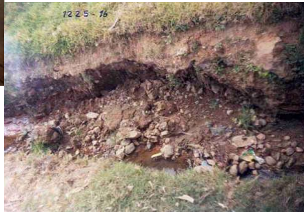
EROSION LATERAL DEL CANAL LAGUNASECA CERCA DE LA INTERSECCION DE LA AV. MANCO CAPAC Y EL CANAL REMONTA 2
