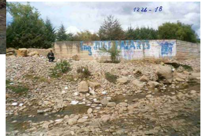
ENROCADO QUE PROTEGE LAS ALETAS DE LA DEFENSA RIBEREÑA DEL RIO CHONTA Y HA SIDO REMOVIDO POR LA FUERZA DEL AGUA. SON ROCAS DE MAYORES A 1,00 METRO DE DIAMETRO
