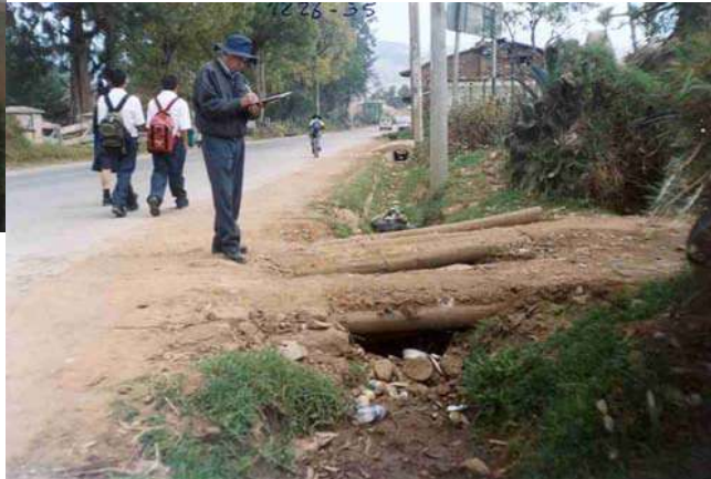
PEQUEÑOS PUENTES EN MAL ESTADO QUE OBSTRUYEN EL FLUJO DEL DREN QUE PASA POR LA AV. MANCO CAPAC
