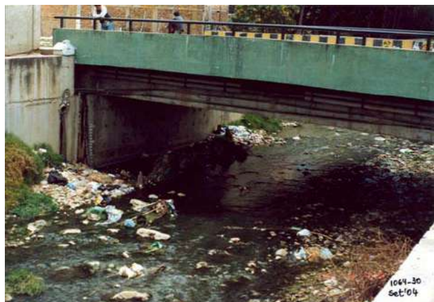
DESPERDICIOS Y RESIDUOS DEBAJO DEL PUENTE DE LA CALLE INCA YUPANQUI EN EL RIO CHONTA.
