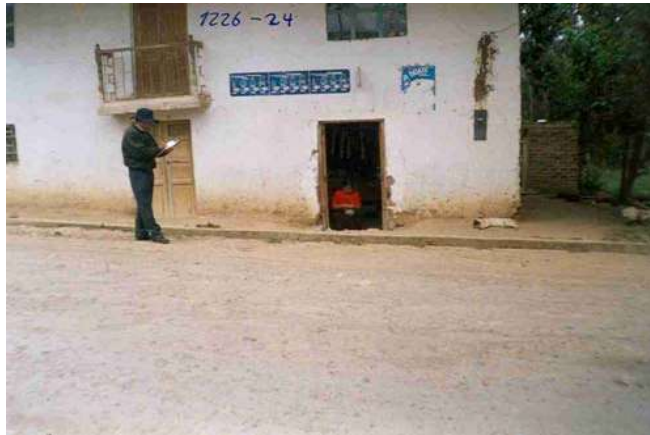
VIVIENDAS AFECTADAS POR INUNDACIONES EN PUYLLUCANA, DEBIDO AL DESBORDE DEL CANAL LUICHUPUCRO-PUYLLUCANA EL CUAL PASA JUNTO A LA CARRETERA
