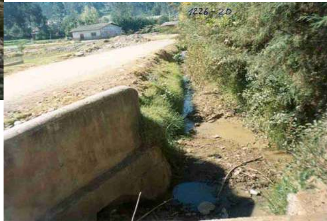
ESTADO EN QUE SE ENCUENTRA LA LOSA QUE CUBRE PARTE DEL CANAL REMONTA 2 DEBIDO A LAS DESCARGAS DE SEDIMENTOS DE LA QUEBRADA MAYOPATA
