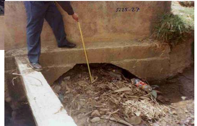
DESEMBOCADURA DE LA QUEBRADA Mayopata, LA CUAL ESTA OBSTRUIDA CON SEDIMENTOS, RESIDUOS VEGETALES Y BASURA
