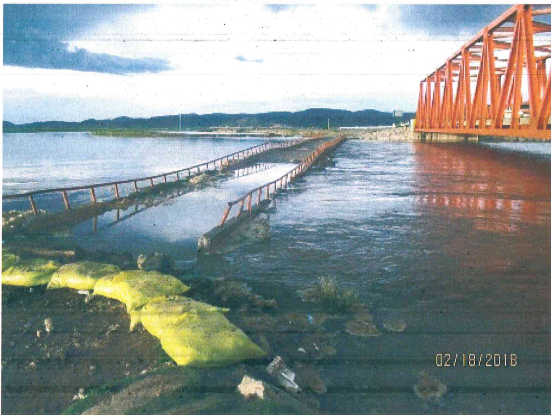
Imagen 05 – Inundación del Rio Coata – Puente en Peligro - Distrito de Caracoto
