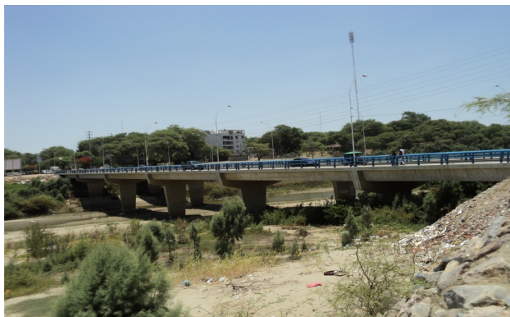
Vista del Puente Cáceres, observar acumulación de desmonte en el estribo izquierdo, sector de Castilla.
