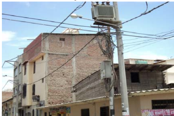
Cables e instalaciones expuestas, centro de la ciudad de Piura
