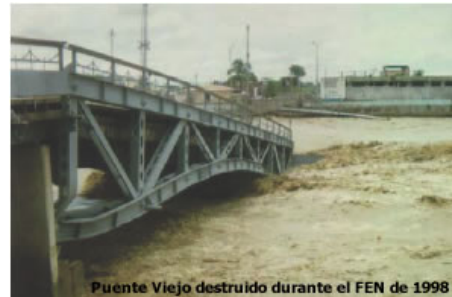
Puente Viejo destruido durante el FEN de 1998
