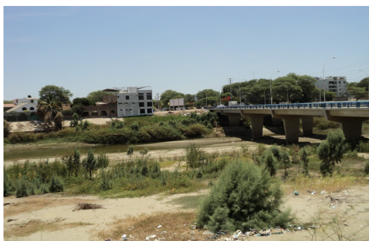
Puente Cáceres, se aprecia la fuerte erosión lateral en la margen derecha del río Piura
