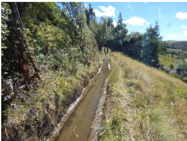
Foto 2. Sector impermeabilizado de Canal Salvador Coremayo, rebalsando por exceso de agua.
