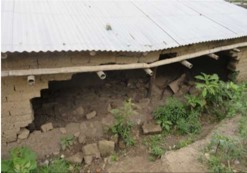
Foto 05: Local provisional del Pronoei en el caserío Porongos afectado por los flujos de detritos, se ubica en la margen izquierda de la quebrada Los Porongos.
