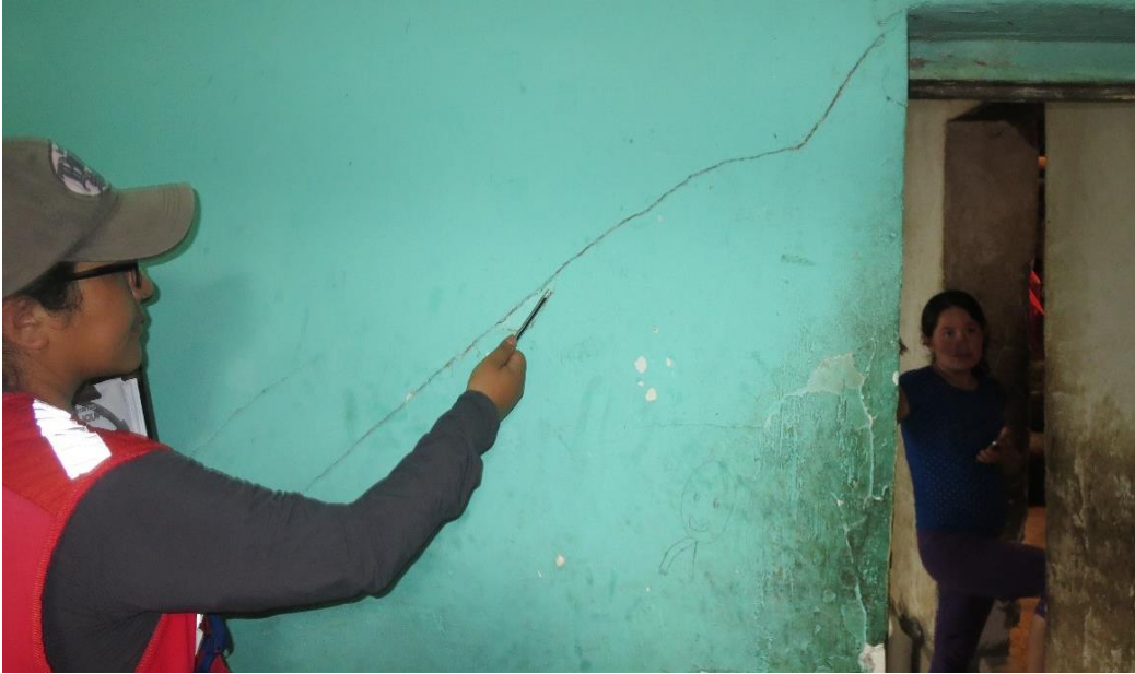
Foto 06: Agrietamientos en una vivienda producto de la reactivación del deslizamiento.
