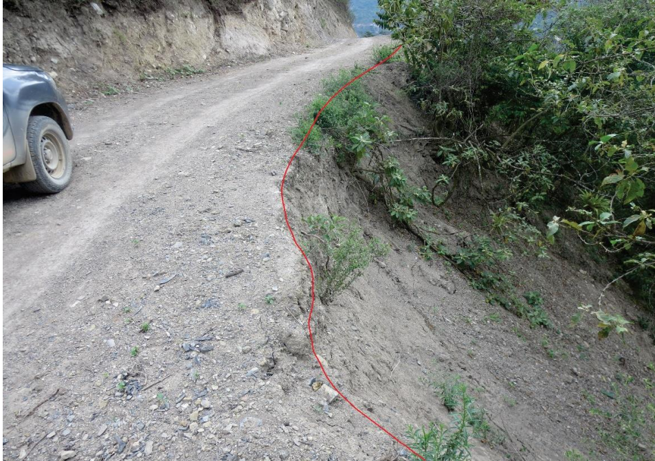
Foto 07: Derrumbe en el talud inferior de carretera que está afectando la única vía de acceso al caserío Palo Blanco
