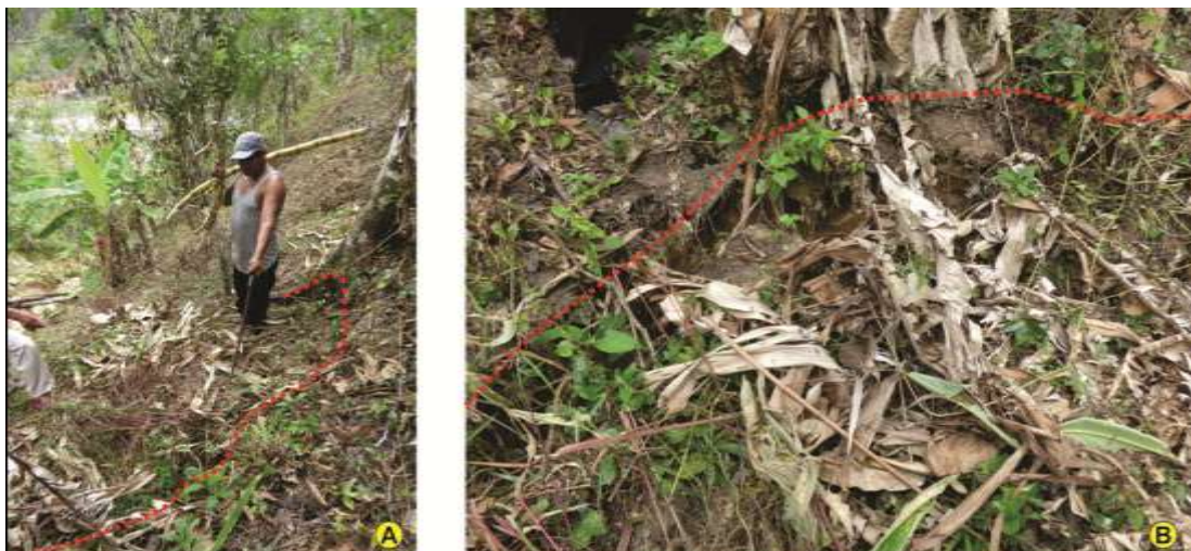
Fotos 15A y 15B, se muestra los agrietamientos del terreno.
