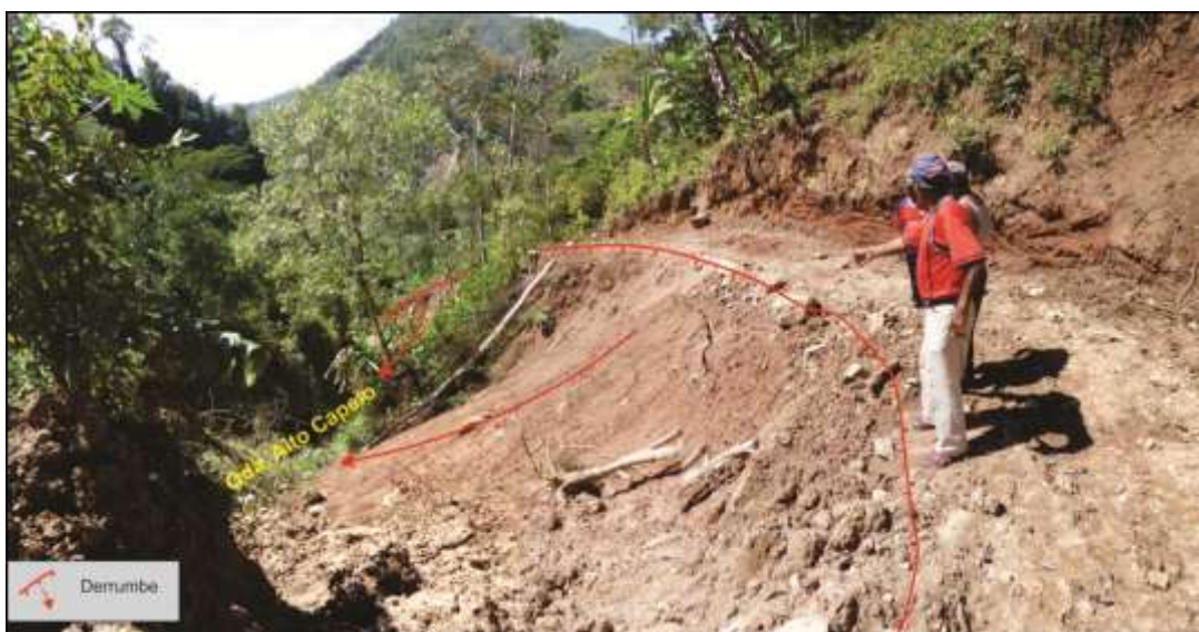
Foto 8. Se muestran derrumbes que se encuentran en la margen izquierda de la quebrada Alto Capelo.
