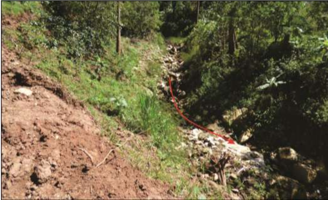
Foto 7. Cauce de la quebrada Alto Capelo, con material suelto de fácil remoción.
