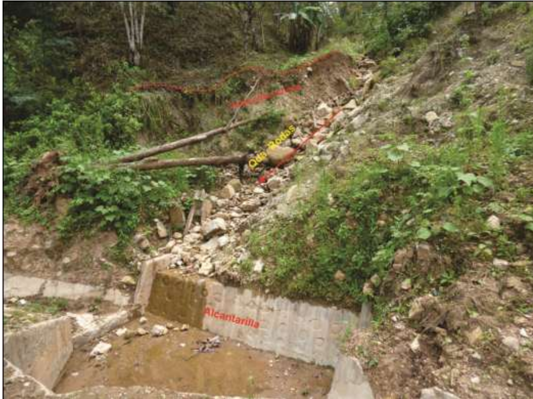
Foto 14. Se muestra la alcantarilla y la parte ensanchada de la quebrada Rodas.
