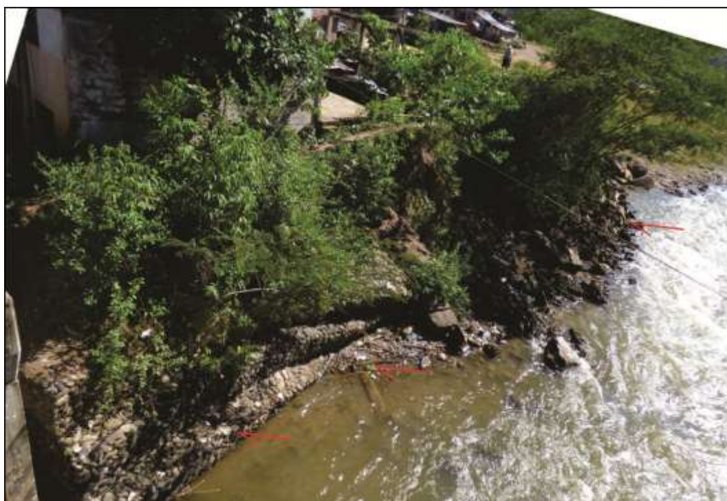
Foto 17. Erosión en la defensa ribereña (gavión) del puente Capelo.
