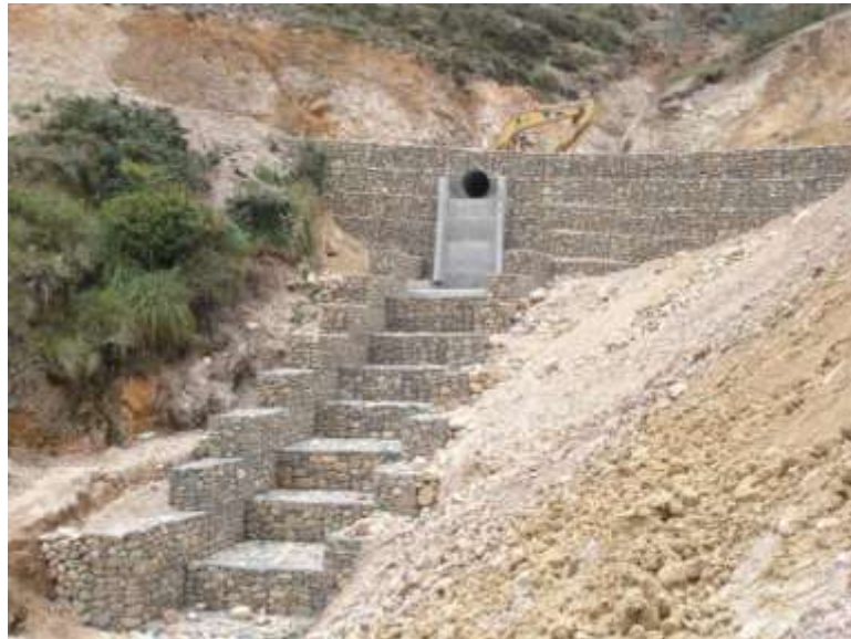
Foto 21. Dique transversal de gaviones reforzado con contrafuertes para mayor resistencia al impacto del flujo. Ambos son diques completamente cerrados.
