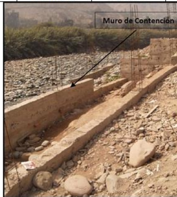
Figura 33: Presencia de barreras de contención construidas en terrenos no compactos por lo tanto se observa erosión en su base. En la figura de abajo se observa que el agua del río Rimac se encuentra a nivel de la base de la vivienda que está en etapa de construcción.
