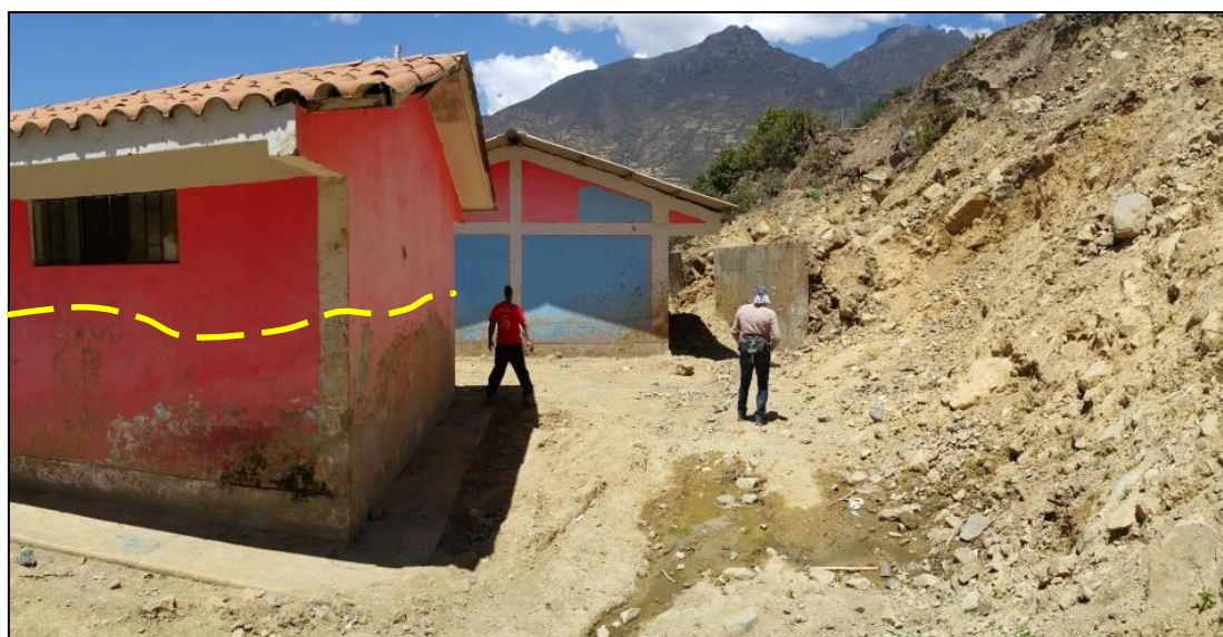
Foto 11: Marcas dejadas en los muros de los baños y aulas de la I.E. Andrés Pascual, en el extremo sur de la zona de estudio.
