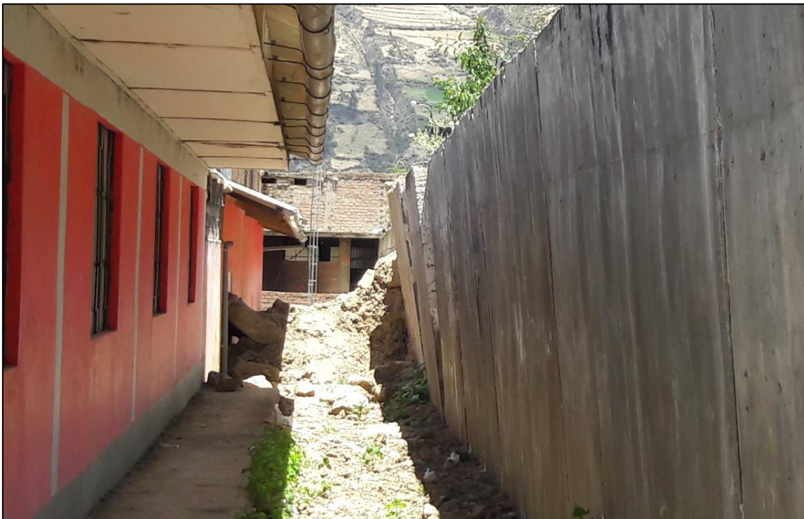
Fotos 8 y 9: Muros de contención inclinados y colapsados a espaldas de la I.E. Andrés Pascual.
