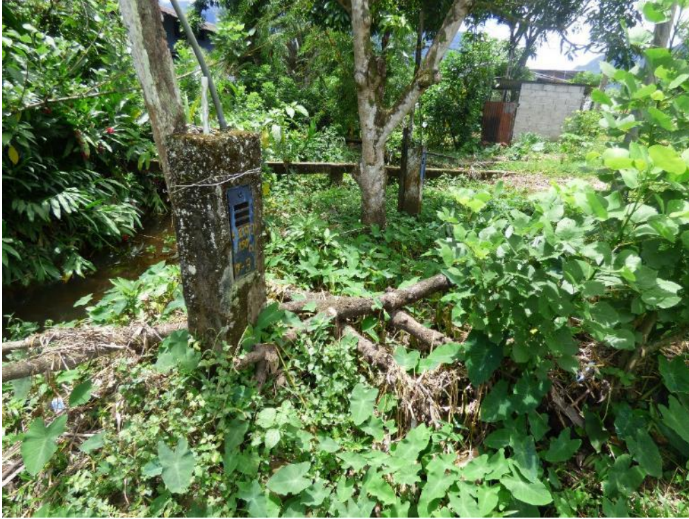
Foto 7. Medidores de corriente eléctrica que podrían ser afectados por las inundaciones
