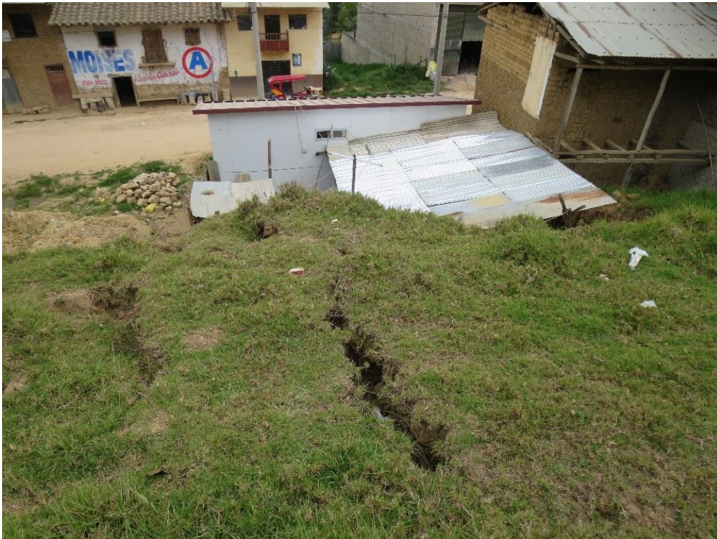
Foto 04: Agrietamientos transversales al cuerpo del deslizamiento, con abertura de hasta 15 cm
