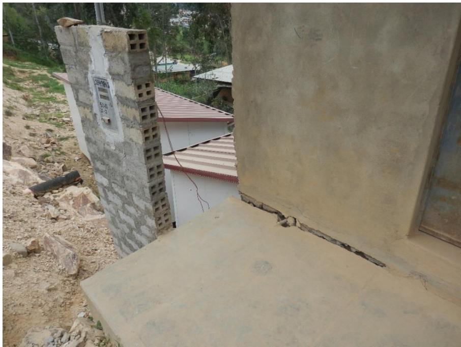
Foto 06: Vivienda afectada por el movimiento del deslizamiento
