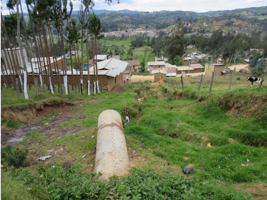
Foto 10: Cárcavas y asentamientos en las laderas del Barrio Carniche y Los Olivos
