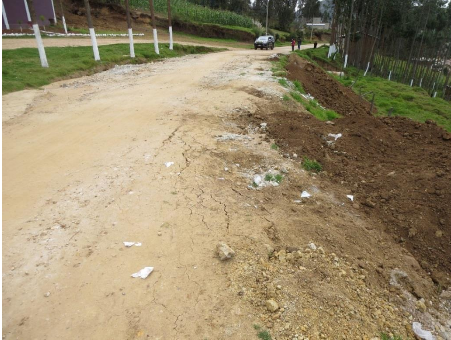
Foto 07: Agrietamientos en la vía de acceso a la ciudad de Cutervo, frente al cementerio privado Nuevo Mundo.
