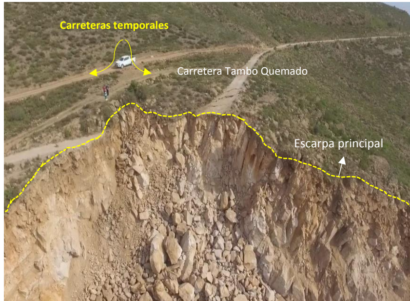
Foto 15: Vista de trazos temporales ejecutados por los pobladores después del colapso de la carretera Tambo - Quemado.
