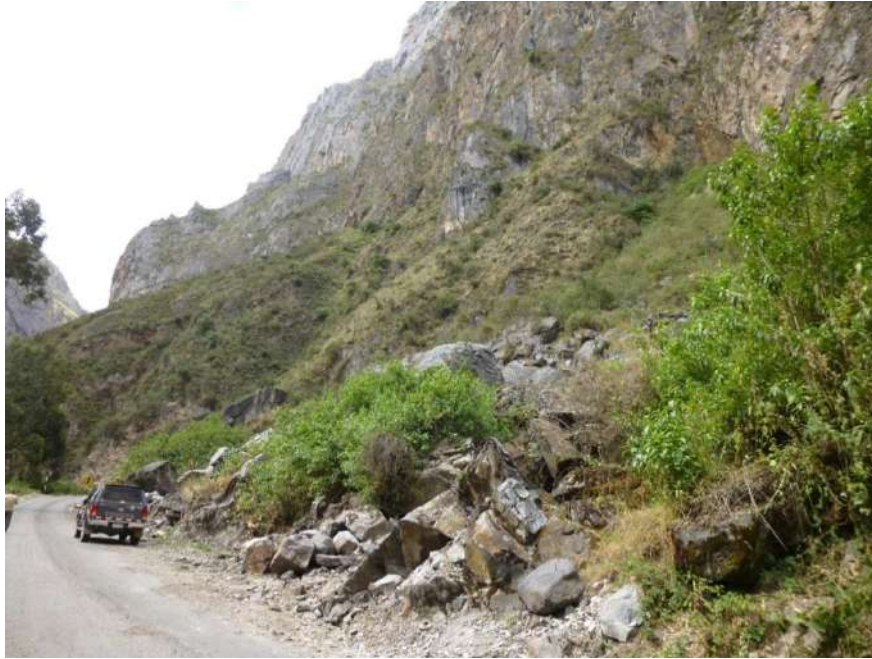
Foto 1. Derrumbes con bloques muy grandes que llegaron hasta el río. Aún se observa activo y material colgado que al caer afecta a la carretera hacia el sector de Altocunuyoc.
