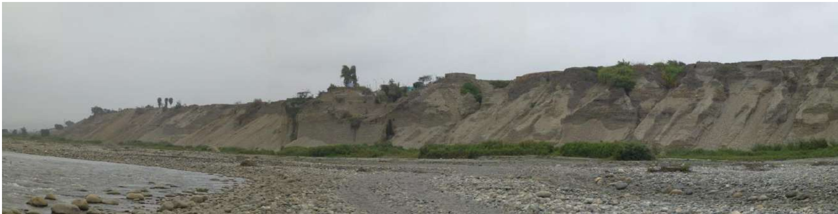
Foto 7. Vista panorámica de los derrumbes y erosión de laderas en la margen izquierda del río Pativilca, debido a la fuerte pendiente de la terraza constituido de gravas englobados en una matriz areno limosa, sector Garita (Barranca).
