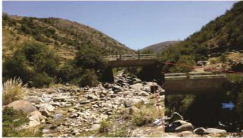
Foto 15. Flujo de detritos, conformado por materia de gran dimensión que deteriora la estructura de un puente, Caracpampa, distrito de Haquira.
