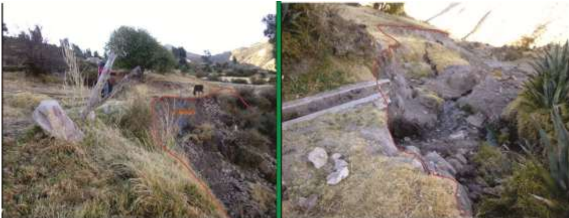
Fotos 6 y 7. Se observa un canal de agua roto en el cuerpo del deslizamiento de Cconchayoc (Anexo Ccayao, distrito de Haquira).
