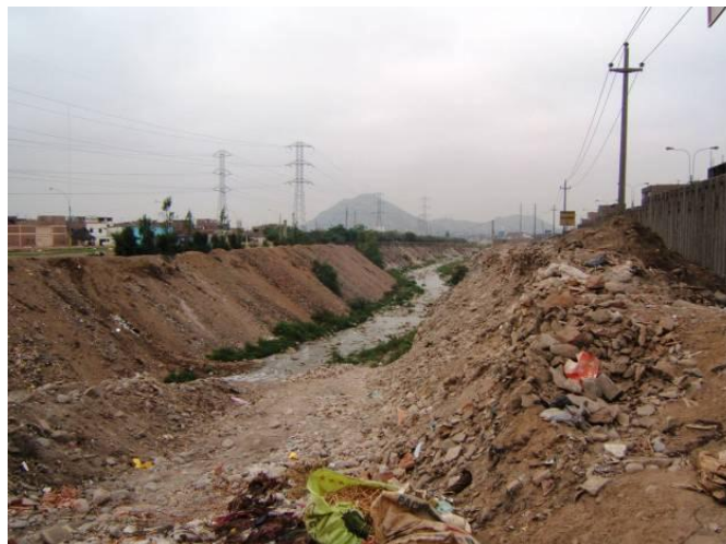
Foto 12. Terraplenes hechos de depósitos de basura y desmonte, que son erosionados por los procesos de erosión fluvial. (Fuente: INGEMMET, 2009)
