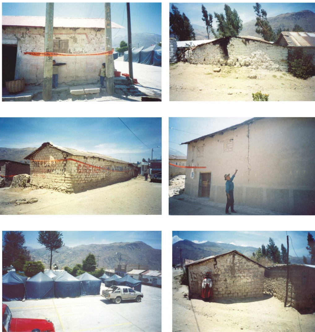
Figura 10. Imágenes que muestran los daños ocasionados por el sismo del 1 de octubre en la localidad de Calacoa. Observese que el material de las viviendas es de adobe y quincha con techos de madera y calaminas. La foto inferior muestra la ubicación de las carpas de emergencia utilizadas por la población.
