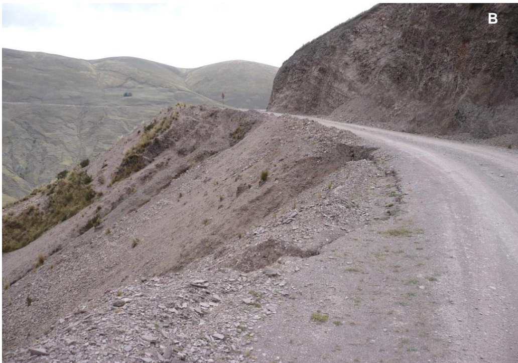
Foto 13: Derrumbes en el talud superior de la carretera Vinchos-Jarica, en la margen izquierda del río Condoragra, afecta varios tramos de la carretera (A y B).
