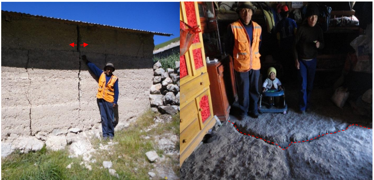
Foto 28: Presencia de grietas en viviendas del sector Chicchi Ucra, las cuales aparecieron después del evento del 18 de Abril del 2011.
