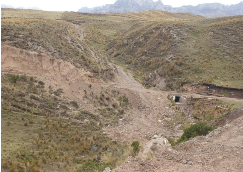
Foto 17: Flujo de detritos en el río Curucuta, afecta tramo de carretera Pasco-Huachos-Yanahuanca y alcantarilla.
