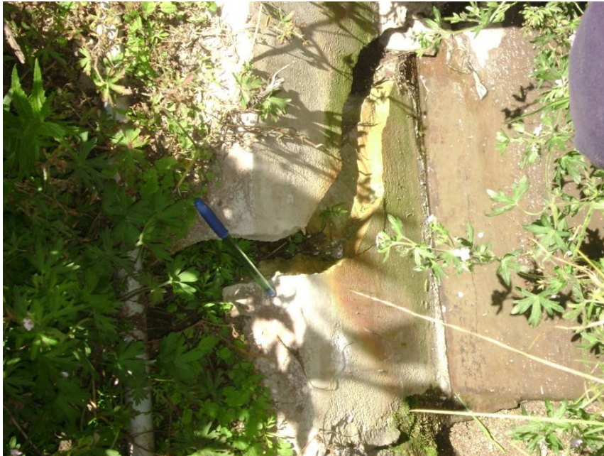
Figura 10: canal de irrigación afectado por la reactivación del deslizamiento.
