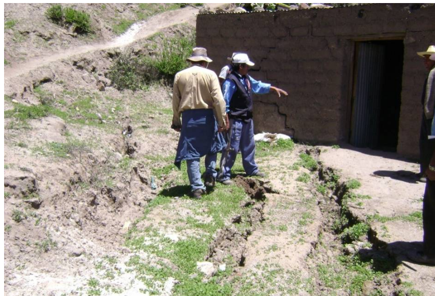
Figura 8: Vivienda de Amata afectada por las grietas generadas a partir de la reactivación del deslizamiento.
