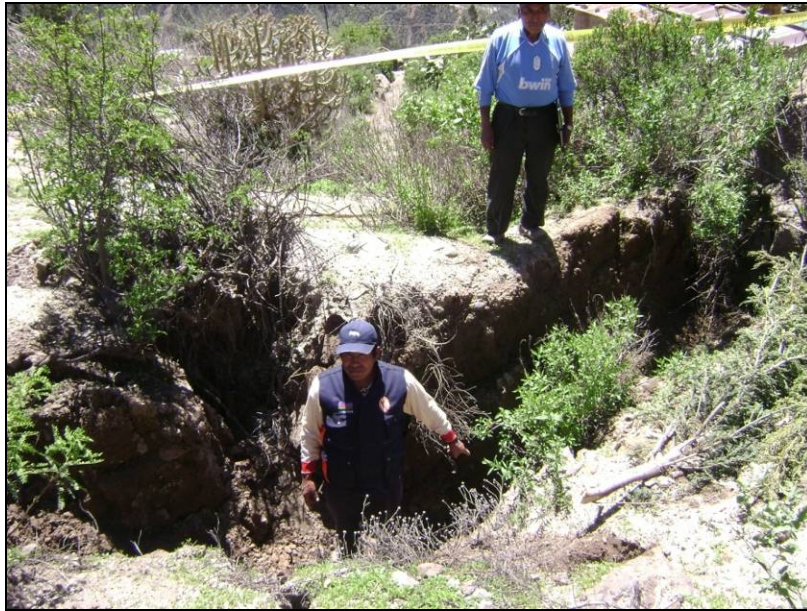
Figura 5: Grieta tensional del deslizamiento de Amata.
