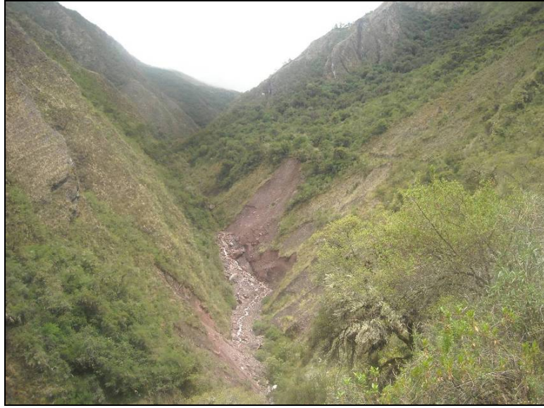
Figura 24: Se observa el socavamiento causado por el río Samas en ambas márgenes, producto de este debilitamiento en la base del talud se dan los colapsos y deslizamientos.
