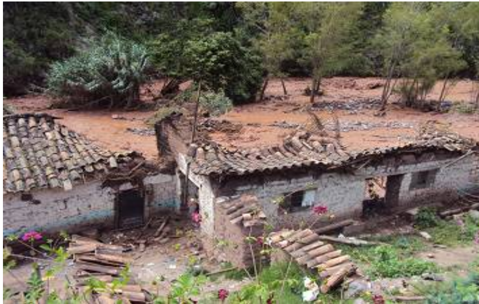
Figura 13: Vivienda afectada en el poblado e Limatambo. Tomada del registro fotográfico de la Municipalidad de Limatambo.
