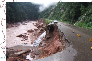
24.-Sector Ducha del Diablo, donde la carretera Federico Basadre fue afectada en un tramo de 230 m. se aprecia el afloramiento de las armaduras. La erosión fluvial afectó parte del relleno.
