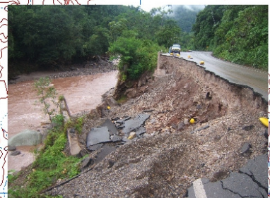
20.-Sector Juan Velasco, la erosión fluvial generó derrumbes en el borde de talud, afectando parte de la carpeta asfáltica de la carretera Federico Basadre.
