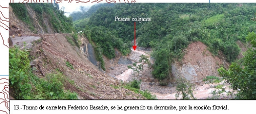
13.-Tramo de carretera Federico Basadre, se ha generado un derrumbe, por la erosión fluvial.
