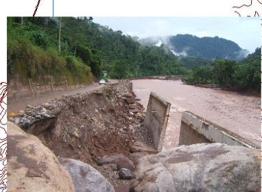
21.- Sector Juan Velasco, erosión en la margen izquierda del río Yuracayacu, que afectó la carretera Federico Basadre en su tramo de 100 m.
