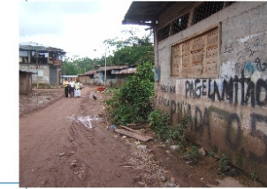
26.-Localidad de Aguaytia, en las paredes se muestran las señales hasta donde llegó el nivel de las aguas, producto del desborde del río Aguaytia.
