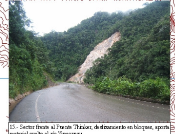
15.- Sector frente al Puente Tankor, deslizamiento en bloques, aporta material suelto al río Yuracayacu.
