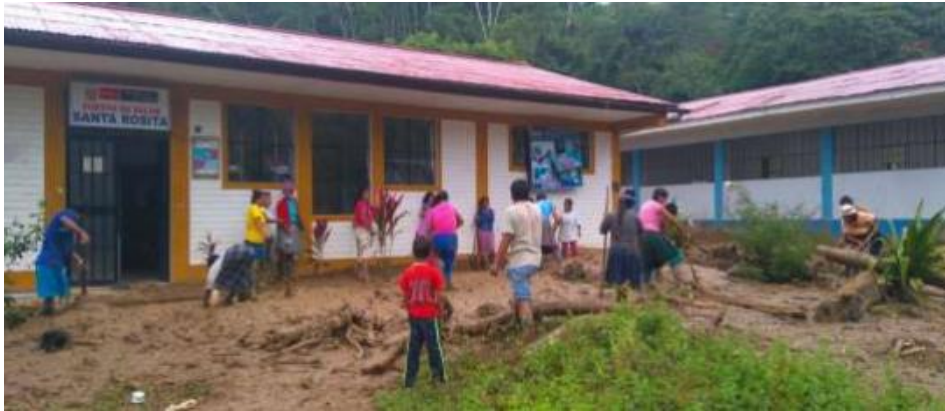
Foto 8: Vista de la Posta médica Santa Rosita afectada por flujo de lodo. Fuente COEN – INDECI 2016.
