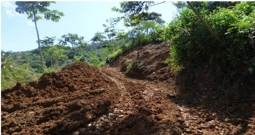
Foto 13: Corte de talud para la construcción de camino carrozable, que ha generado inestabilidad en el terreno.
