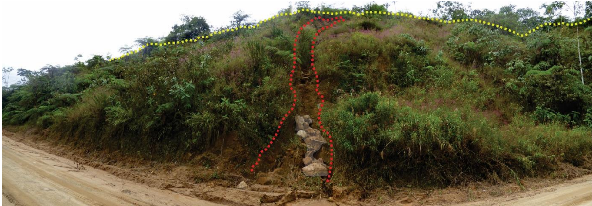
Figura 13: Erosión de ladera, en el cuerpo del deslizamiento activo (D1).
