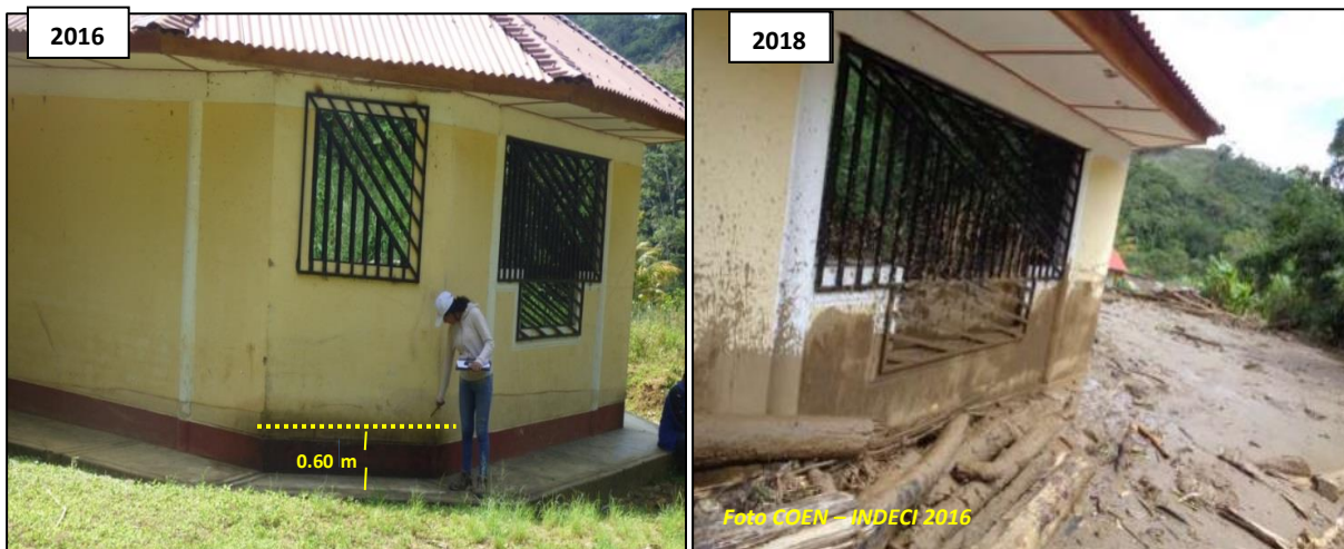
Figura 8: El centro inicial Santa Rosita, fue afectado por el flujo de lodo (2013). Vista de la marca dejada por el paso del flujo de lodo (2018).
