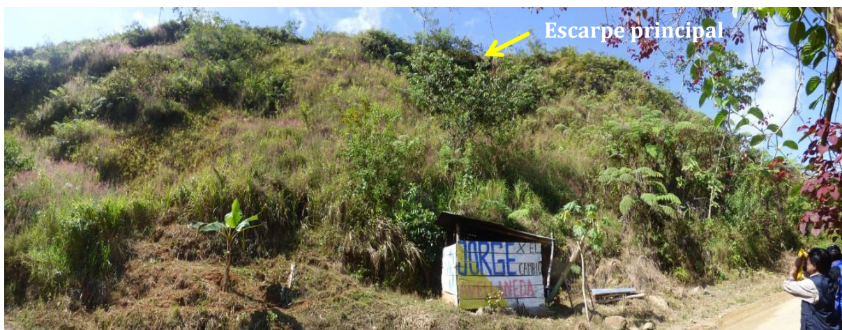
Figura 14: Deslizamiento rotacional, afecto la carretera antigua Satipo- Huancayo.
