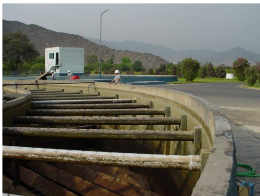
Figura 94. Vista de un decantador
