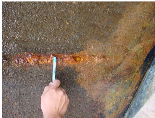
Figura 93. Corrosión del refuerzo en los muros de los decantadores.
