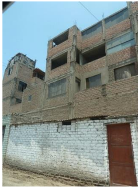
Figura 17. Edificación de mampostería de 4 niveles. Manzana 402. Uso para vivienda. Mal estado de conservación.
