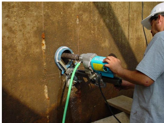
Figura 92. Extracción de testigos de concreto endurecido. Obsérvese la corrosión en el muro
