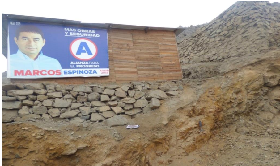
Foto 14: Viviendas ubicadas sobre pircas, ante un movimiento sísmico podría desplomarse.
