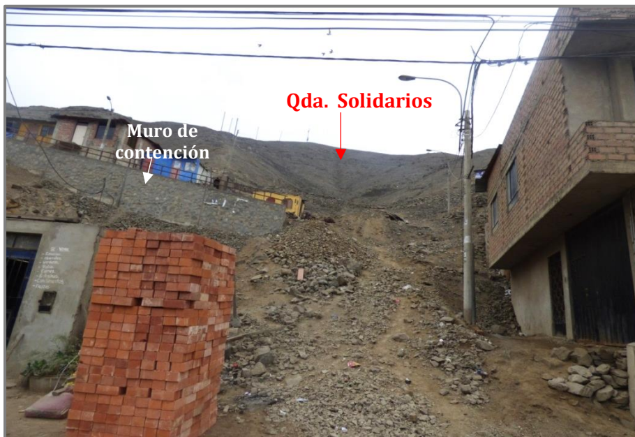
Foto 11: Vista de la quebrada Los Solidarios. Se observa material suelto en su cauce.
