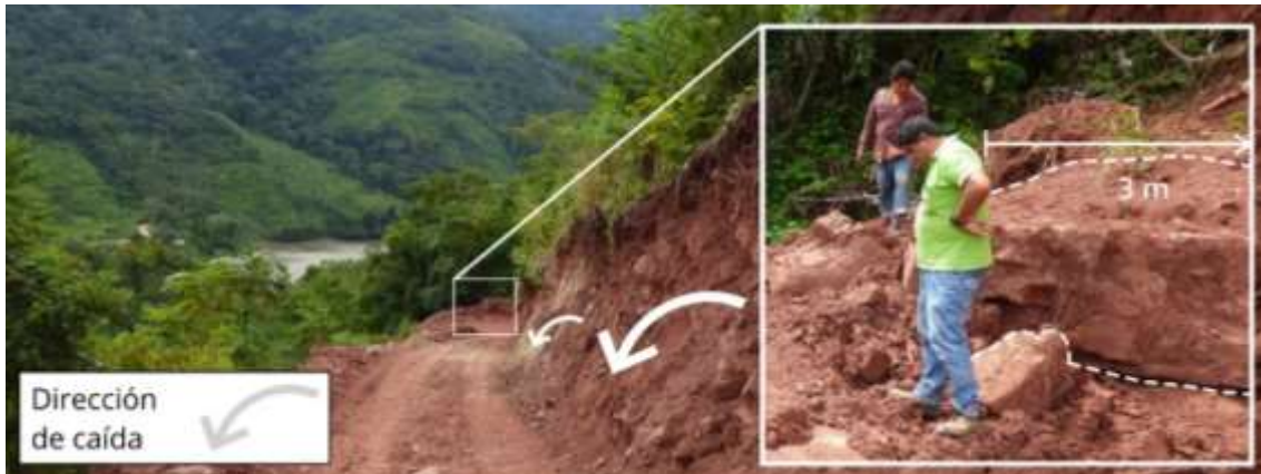
Figura 18. Talud de corte inestable que genera derrumbes y caída de rocas..
