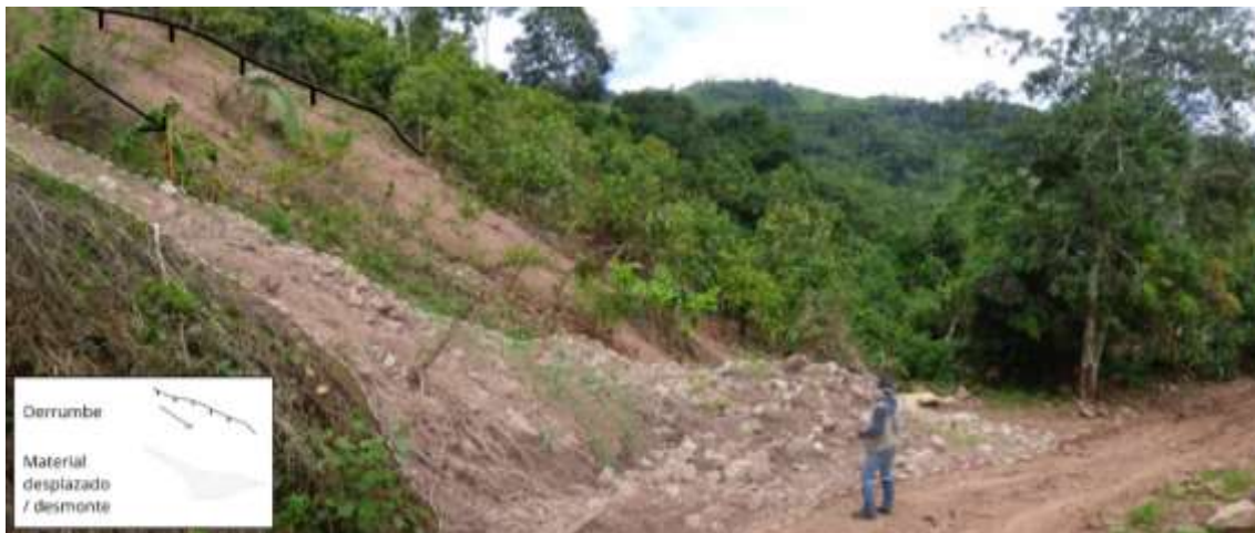
Figura 19. Talud inestable, que muestra derrumbe.
