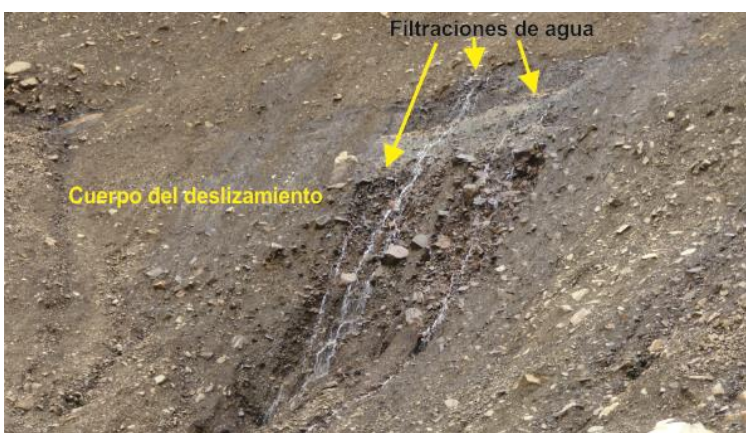
Figura 15. Se aprecian filtraciones de agua en el cuerpo del deslizamiento.
