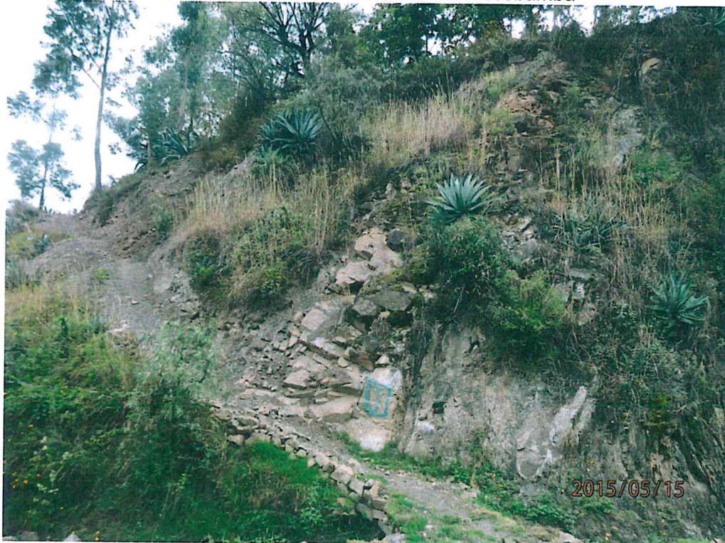
Foto 5: Vista de la Formación Chicama donde se observa una intercalación de lutitas, areniscas finas y areniscas cuarzosas con buzamiento noroeste, en el km 27+640 carretera a Piscobamba
