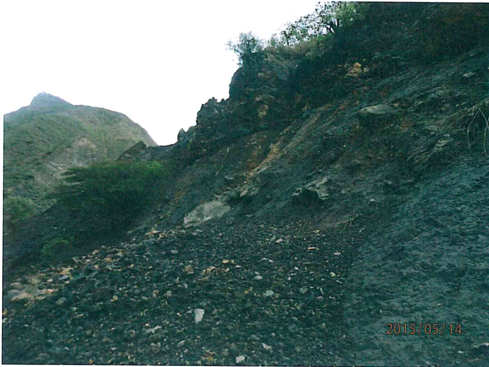
Foto 12. Vista de las lutitas carbonosas con buzamiento a favor de la pendiente, que determina superficie deslizando, viendo al noreste
