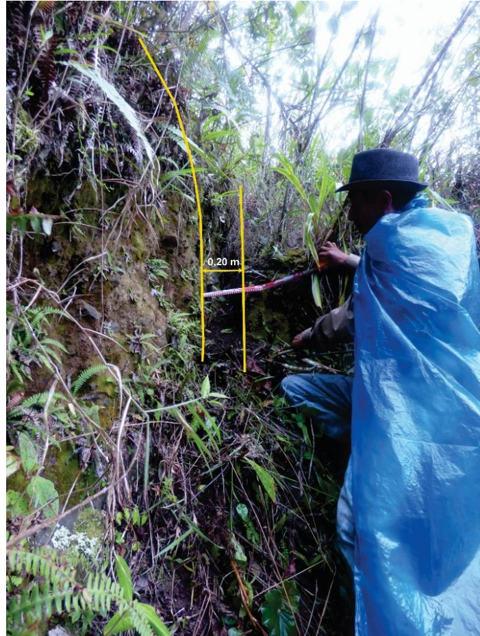
Foto 7: Grieta perpendicular a la escarpa principal del deslizamiento antiguo, se observa la abertura de 0,20 m y el asentamiento del terreno que produjo.
