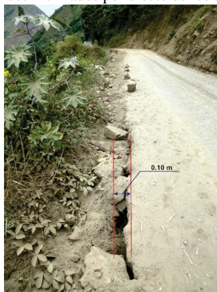
Foto 5: Vista donde puede observar los agrietamientos con aberturas de 0,10 m en el borde de la plataforma de carretera (mayo 2013).
