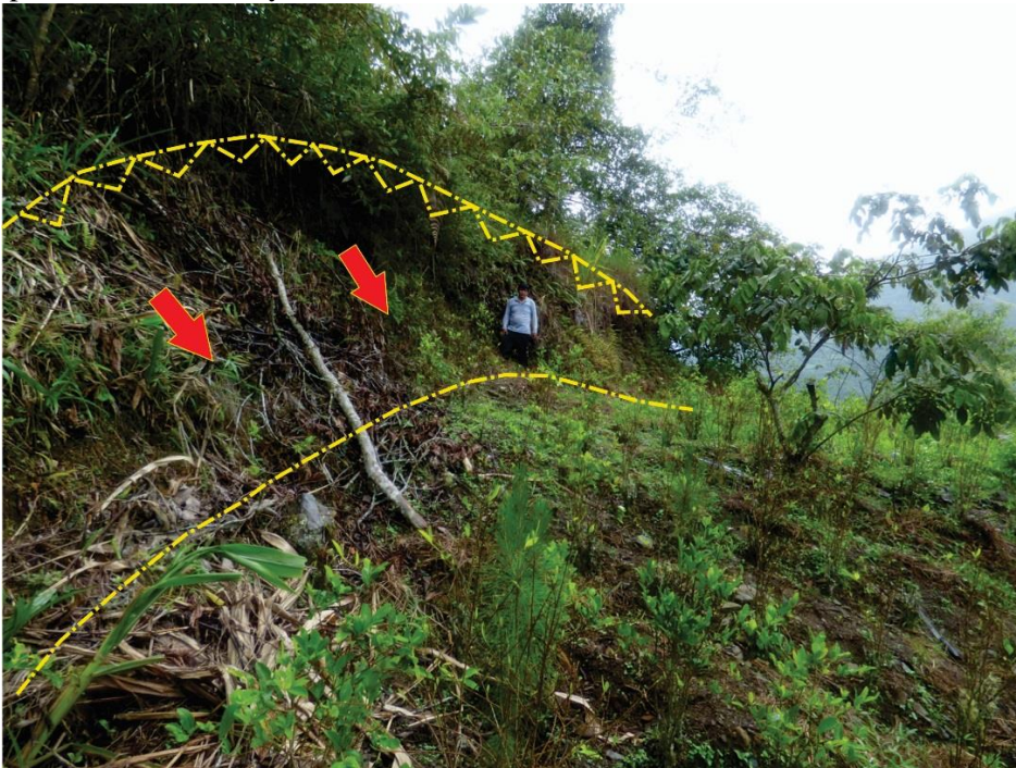
Foto 6: Vista hacia el Este donde se ha marcado con líneas color amarillo la escarpa principal del deslizamiento antiguo.
