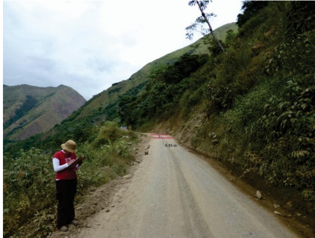
Foto 3: Vista en la que puede observar los asentamientos (0,15 m) en la plataforma de carretera (mayo 2013)
