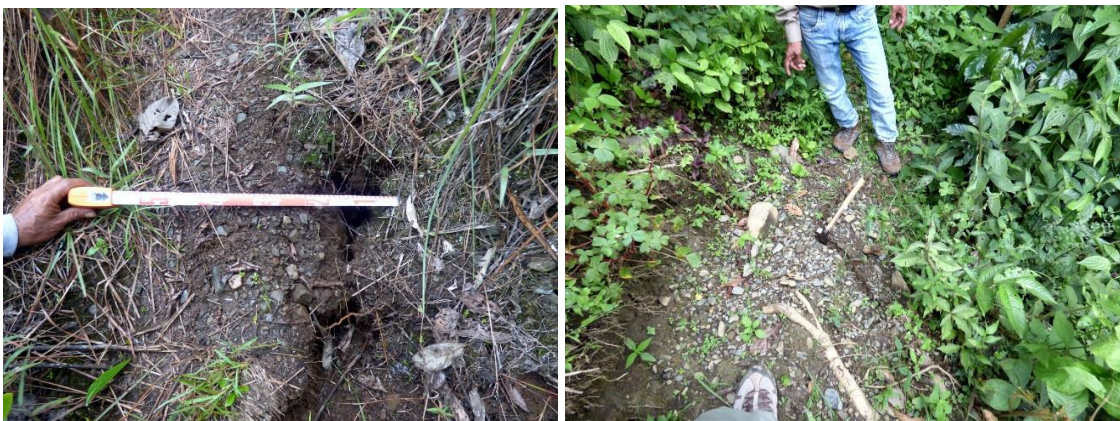
Fotos 12 y 13: Vista en donde se puede observar el agrietamiento abierto en el terreno localizado por encima de la corona del deslizamiento traslacional de Kuquipata.
