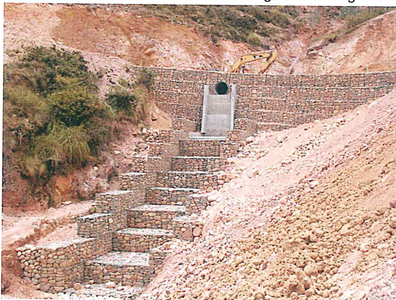
Foto 30. Dique transversal de gaviones reforzado con contrafuertes para mayor resistencia al impacto del flujo. Ambos son diques completamente cerrados.
