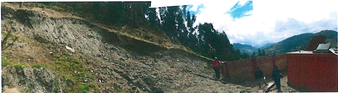
Foto 22. Perímetro del reservorio de agua potable colapsado.
