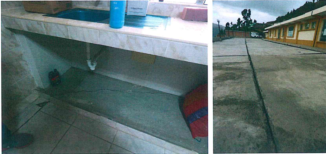
Fotos 20 y 21. En la vista de la izquierda, piso con agrietamiento. Vista de la derecha, la loza está deformándose.
