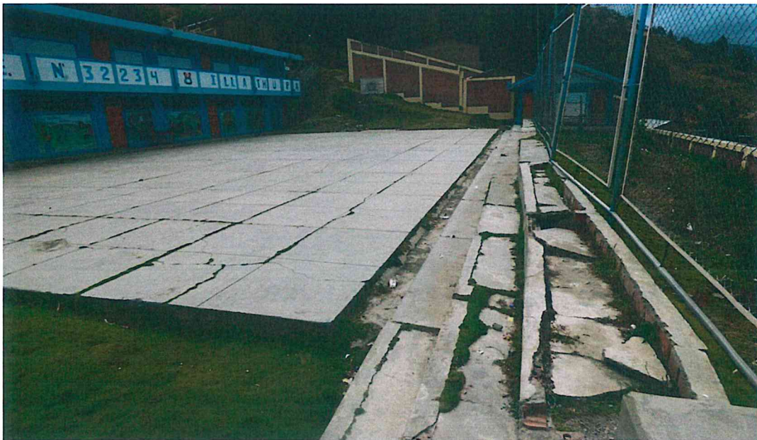
Foto 17. Agrietamientos en loza deportiva y tribuna colapzada.
