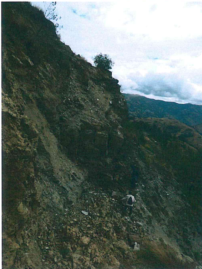
Foto 32. Parte de la escarpa del derrumbe, en su talud se observan bloques de roca sueltos inestables.
