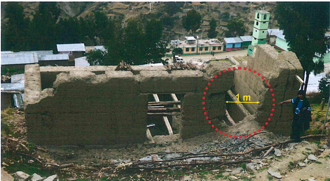
Foto 30. Área de impacto del bloque de roca, proveniente del derrumbe, sobre la pared de una vivienda.
