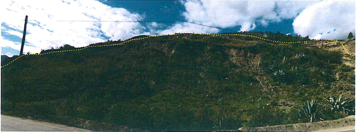
Foto 5. Depósito generado por deslizamiento (enmarcado con línea amarilla).
