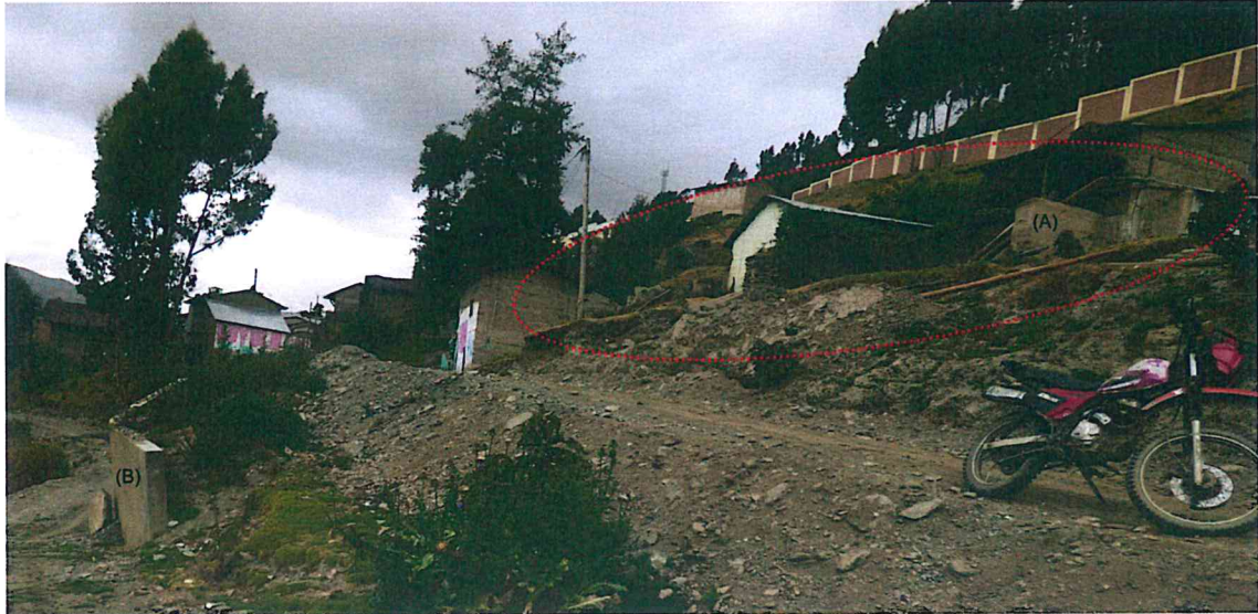
Foto 24. Viviendas afectadas por el deslizamiento, se aprcia agrietamientos en las paredes (A), como también muro de contención inclinado (B), por efectos del empuje del terreno.
