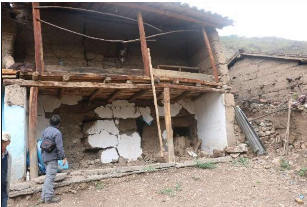
Foto 11: Vivienda de la comunidad campesina San Bernardo de Colpa con graves daños estructurales.
