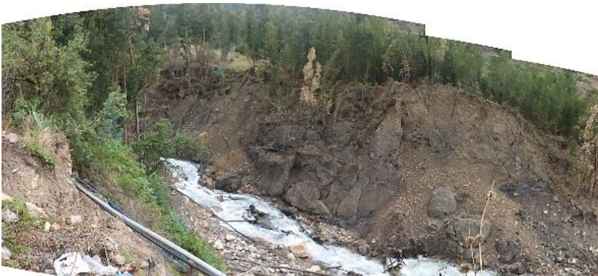
Foto 14: Socavamiento lateral, en la margen izquierda del río Rurichinchay.
