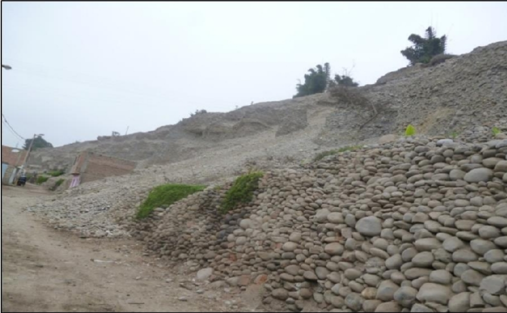
Figura 41: Derrumbre ubicado en el A.H. Las Palmas de Bolívar. La intervención antrópica agrava la estabilidad del talud conformando por gravas redondeadas Mapa geodinámico para la ciudad de Barranca
