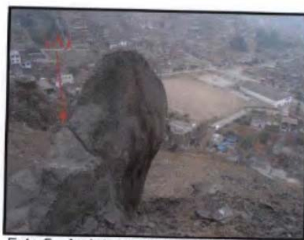
Foto 5.- Agrietamiento (A) del bloque a raíz del sismo del 15 de agosto del 2007.
