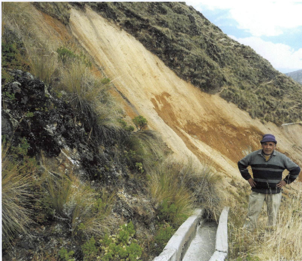
Foto N° 2. Afloramiento de roca volcánica meteorizada y alterada en la escarpa del deslizamiento
