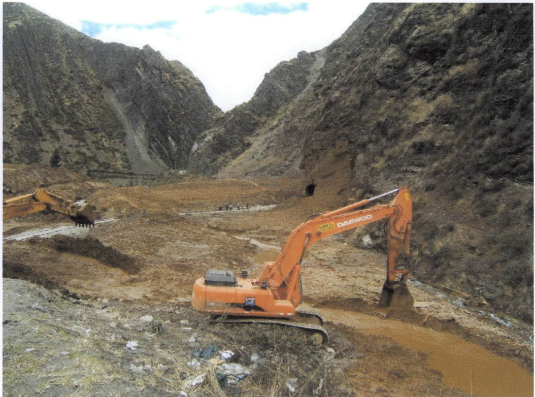
Foto N° 7. Ferrocarril Central, afectado por flujo de detritos
