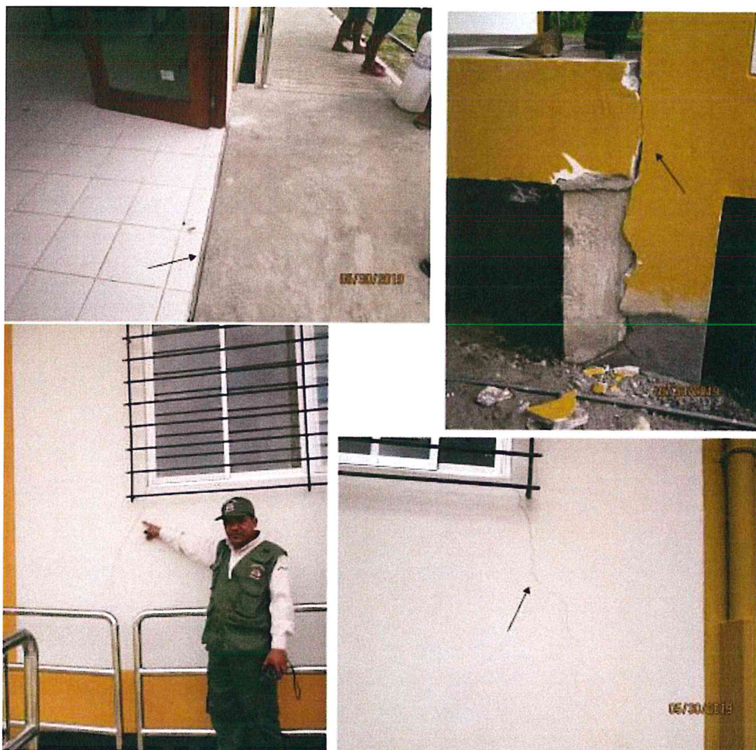
Figura 13. Vista del Centro de Salud Roca Fuerte, construida con ladrillo y concreto, se observa los daños ocasionados en paredes y piso.
