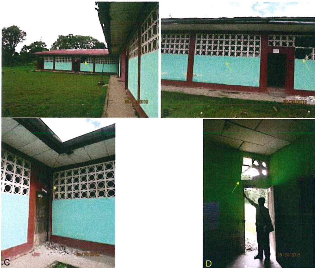
Figura 12. Institución Educativa N°60866, construida con ladrillo y concreto A y B) Nivel primario con grieta en las pared así como la caída de parte de esta. C y D) Nivel secundario también presenta grietas en las paredes y caída de parte de la pared.
