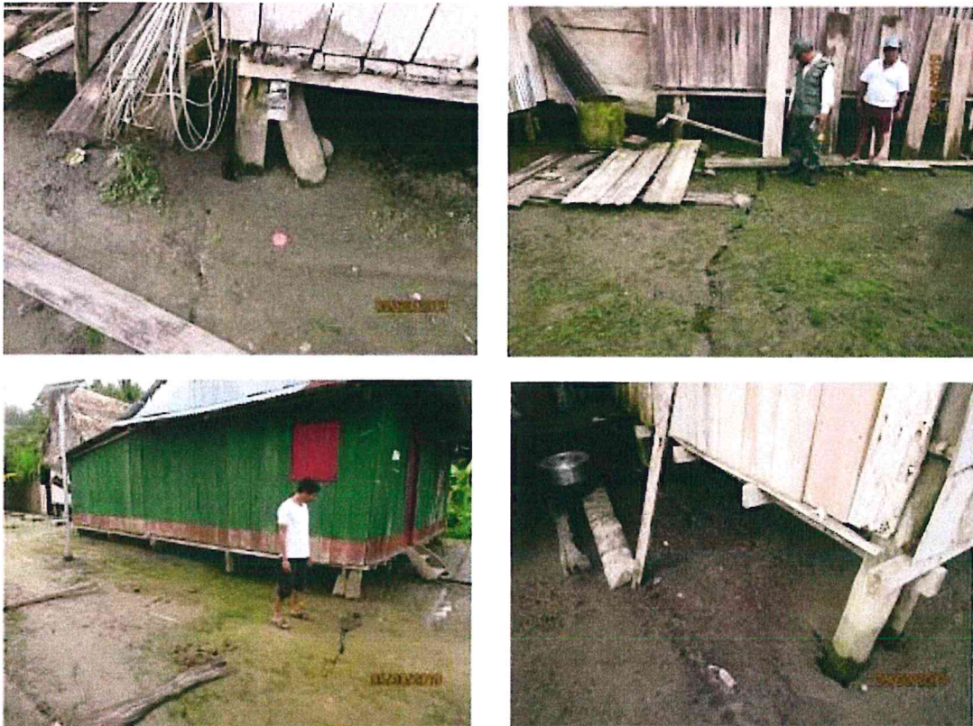
Figura 11. Viviendas del centro poblado, se observa un suelo arenoso, con superficie agrietada, con la estructura de las viviendas con inclinación leve con respecto a su ubicación original.
