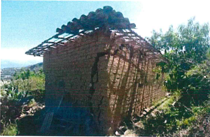
Fotografía 13. Vivienda inhabitable con agrietamientos en las paredes.
