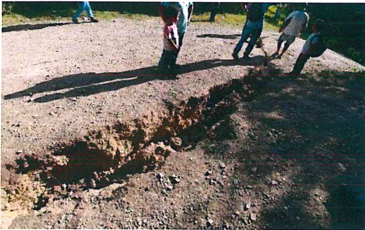
Fotografía 4: Agrietamientos del terreno que afectan la trocha carrozable.
