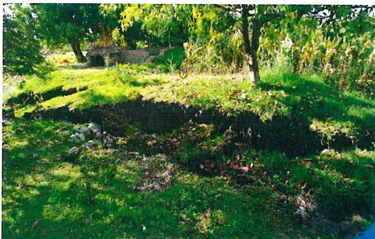
Fotografía 10: Grietas y asentamientos dentro de los terrenos de cultivo en el caserío
