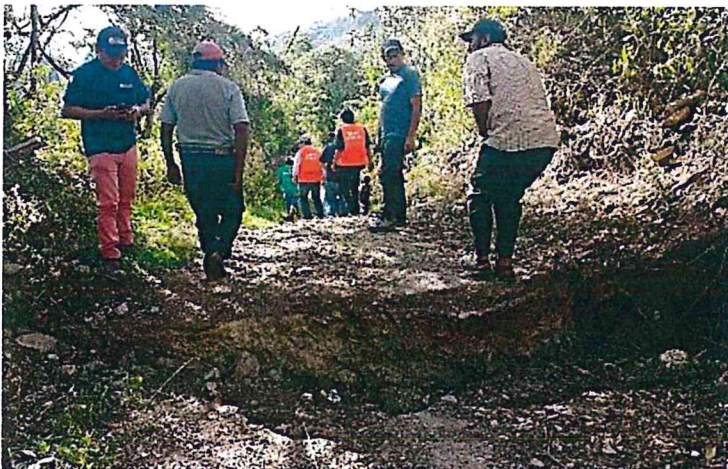
Fotografía 5: Agrietamientos y asentamientos que afectan la trocha carrozable.
