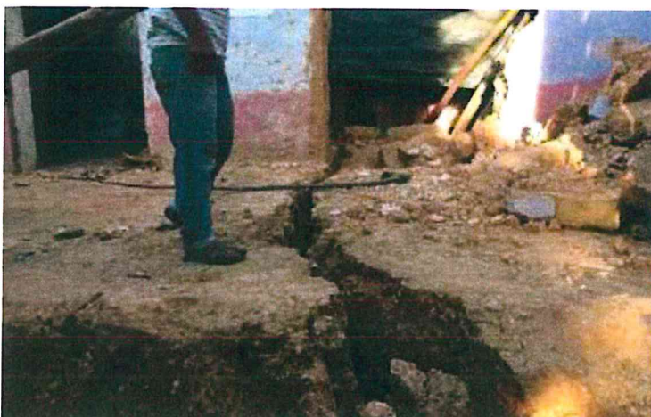
Fotografía 19. Vivienda inhabitable con agrietamientos en las paredes y pisos.
