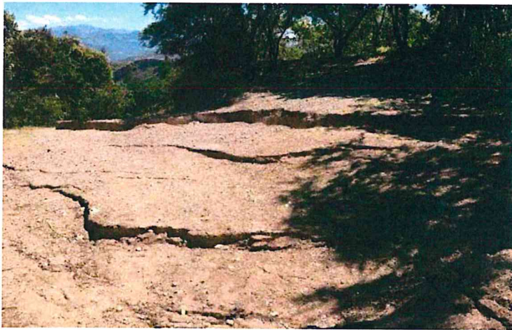
Fotografía 9: Grietas afectan trocha carrozable.
