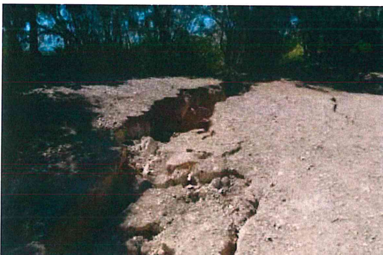
Fotografía 22. Trocha carrozable intransitable, afectada por agrietamiento y asentamiento.
