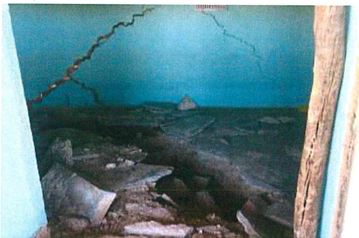
Fotografía 18. Vivienda inhabitable con agrietamientos en las paredes y pisos.
