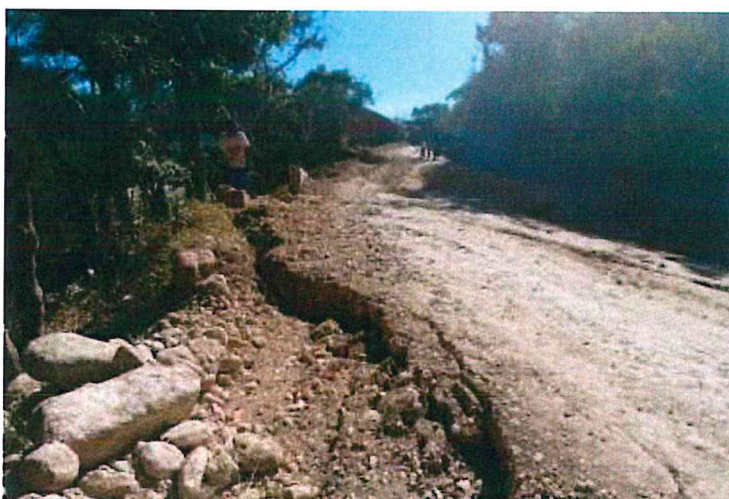
Fotografía 21. Trocha carrozable agrietada en el talud de corte.
