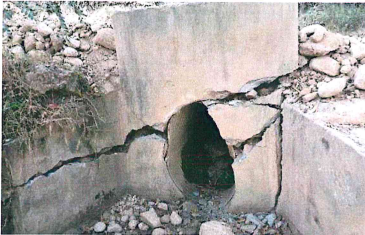
Fotografía 6: Alcantarilla deteriorada por empuje lateral del terreno.
