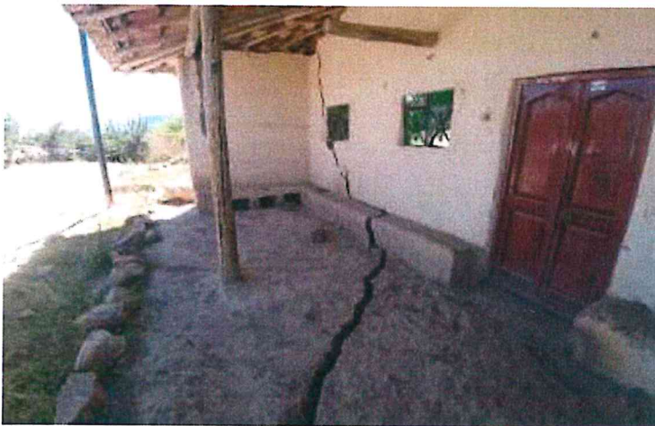
Fotografía 17. Vivienda inhabitable con agrietamientos en las paredes y pisos
