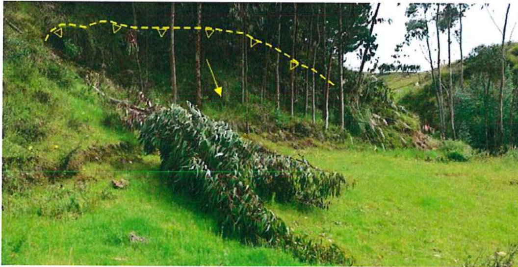
Figura 14. Se muestra corona con línea color amarilla y escarpe principal del deslizamiento antiguo reactivado cubierto por árboles (caídos) y vegetación.
