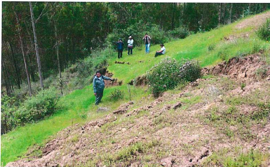
Fotografía 12. Se muestra un escarpe de deslizamiento reciente y material removido que se desplazó en dirección NO.
