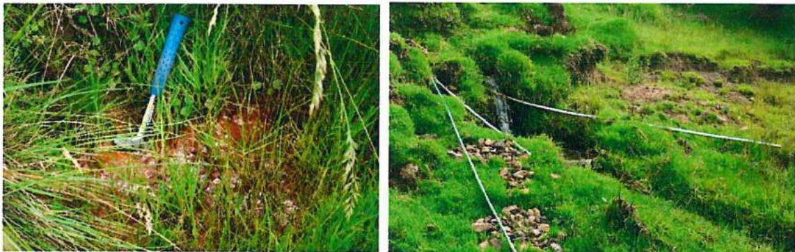
Fotografías 14 y 15. Izquierda: suelos arcillosos saturados de agua. Derecha: presencia de canales sin revestimiento que saturan en terreno y desestabilizan la ladera.
