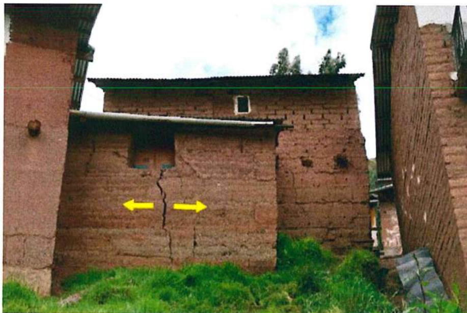
Figura 22. Pared de vivienda del caserío Majtuy muestra agrietamiento vertical y con flechas amarillas dirección de separación.
