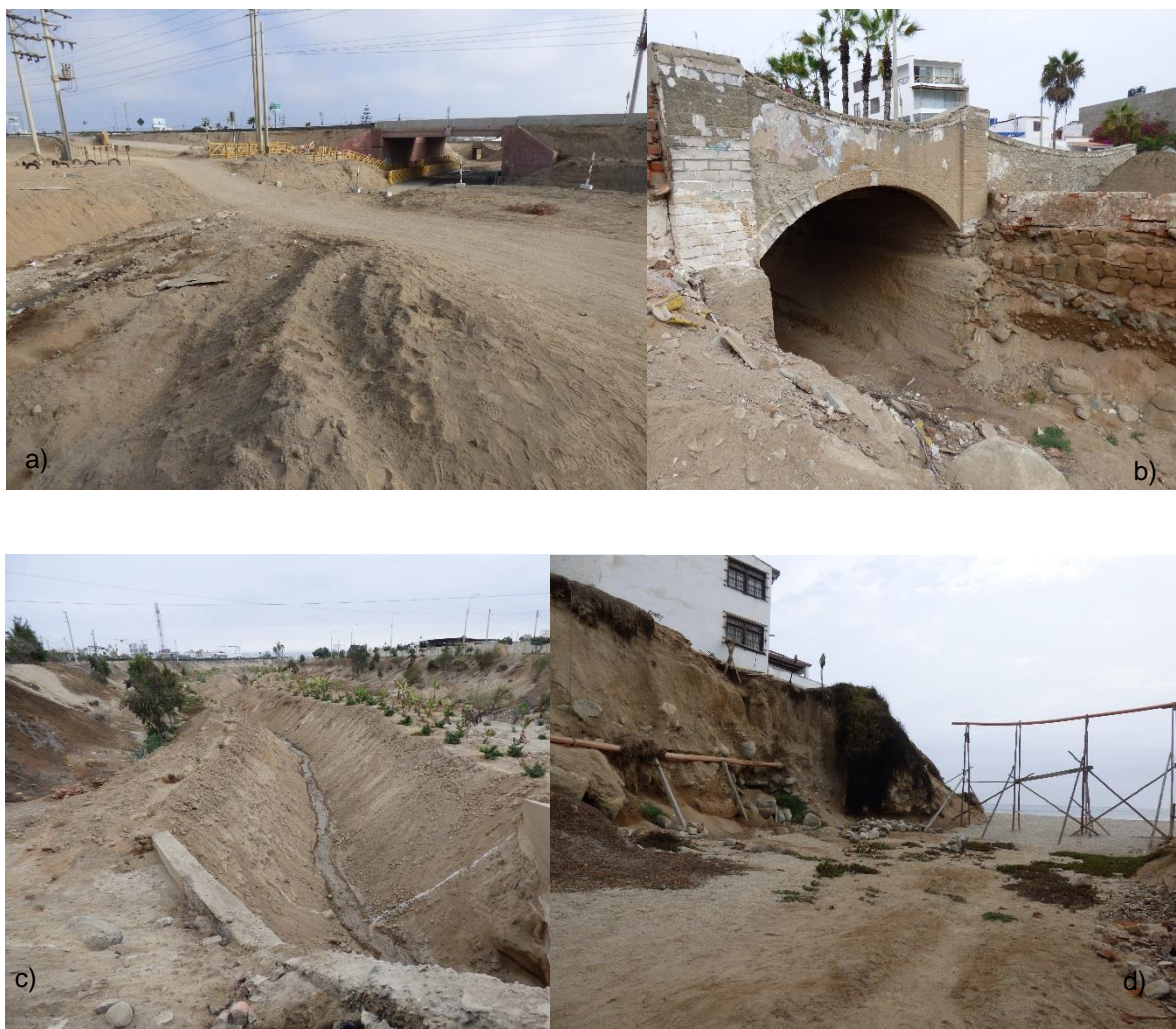
Figura 6. Se muestran los efectos de los flujos de detritos en Punta Hermosa: a) Depósitos de flujos de detritos cerca de la carretera Panamericana Sur, b) Puente peatonal sobre el cauce de la quebrada Río Seco, c) Depósitos de flujos de detritos que rellenan el cauce natural de la quebrada Río Seco d) Desembocadura de la quebrada Río Seco y erosión en la margen izquierda.
