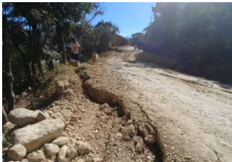
Foto N° 06: Trocha carrozable agrietada en el talu de corte.
