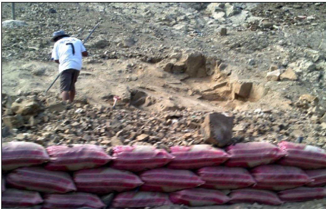
Figura 39: Agrupación de Viviendas Miraflores con presencia de movimientos de masa contenidos con sacos de arena a fin de que no bloquear la carretera de acceso.
