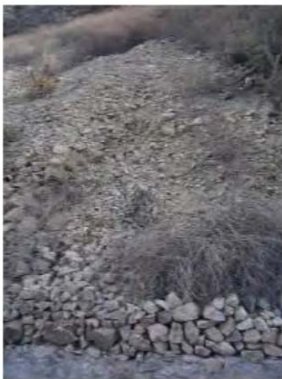
Foto N° 11. Depósitos de derrumbes y pircas construidas para proteger el canal.
