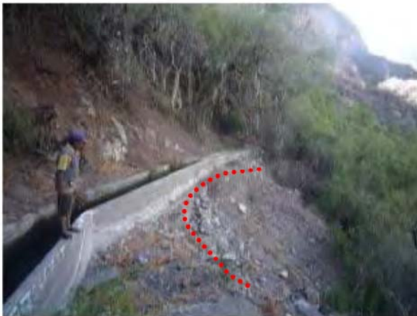
Foto N° 7. Derrumbe en la parte inferior del canal, puede comprometer la estabilidad del canal.
