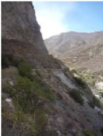
Foto N° 5. Derrumbes en la parte inferior del canal, originados por el desborde del canal, producto de derrumbes y caídas de rocas del talud superior de canal.
