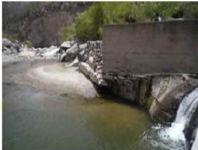
Foto N° 1. Socavamiento en la base del muro.
