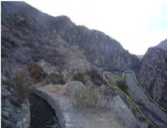
Foto N° 12. Derrumbes y desprendimientos de rocas, pueden dañar el canal en este sector.
