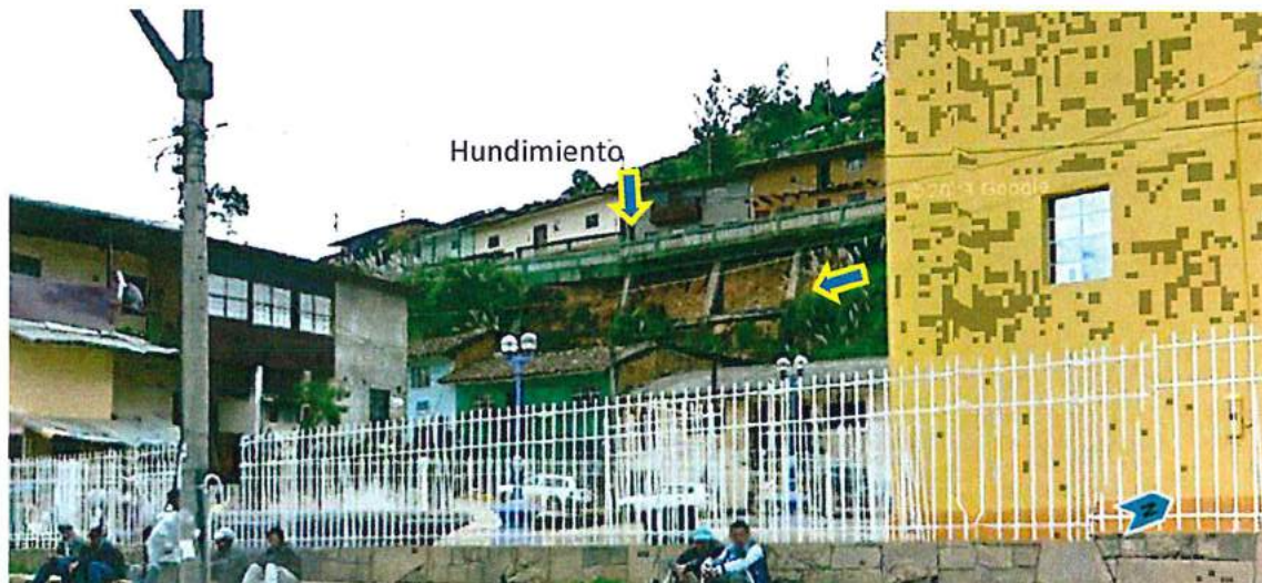
Figura 18. Vista hacia la zona de derrumbes ubicada debajo del malecón.
