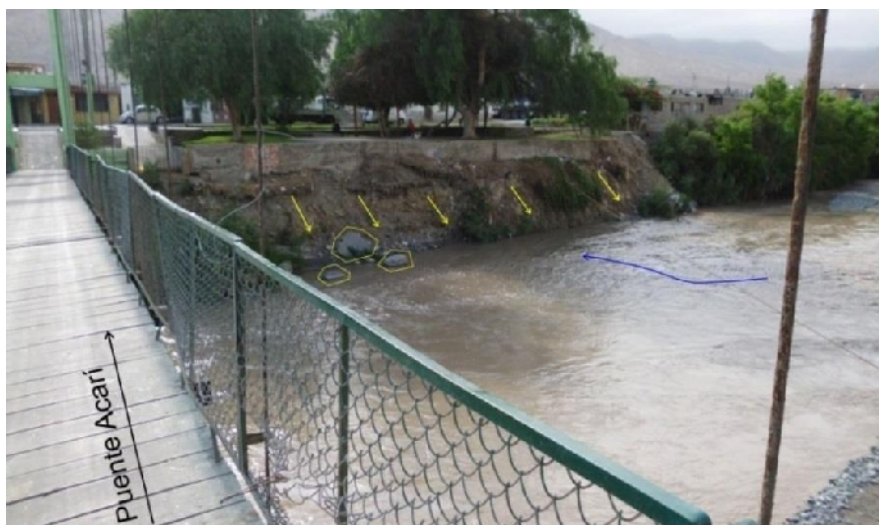
Figura 41: Las bases y secciones laterales del Puente Acarí muestran intensa erosión fluvial. Obsérvese el desprendimiento de materiales que caen al cauce.
