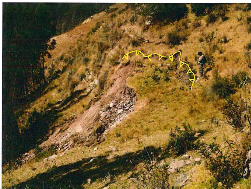
Figura 9. Escarpa principal del deslizamiento ubicado al suroeste de la quebrada Puca Puca. Vista al este
